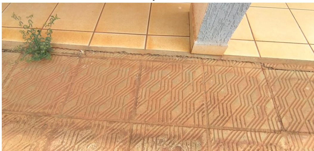
Foto 6: Calçada Externa Danificada
