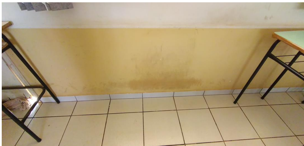
Foto 67: Parede da Sala de Exames Danificada
