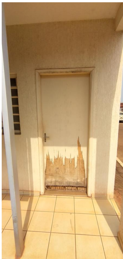
Foto 11: Porta de Acesso a Sala de Exames Danificada
