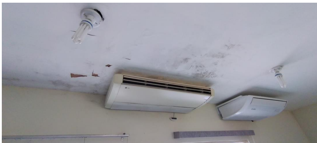
FOTO 68: Laje da Sala de Exames Danificada
