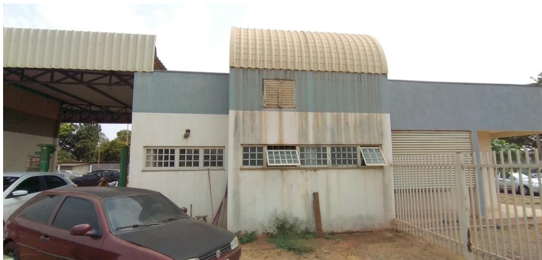
Foto 23; Fachada Lateral Interna Danificada
