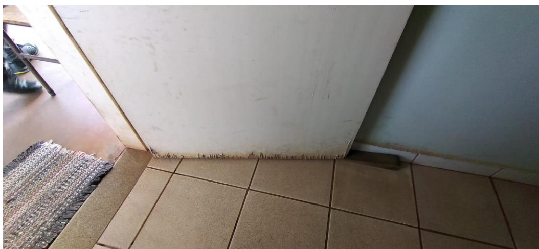
Foto 84: Porta de Acesso a Área de Vistoria Danificada
