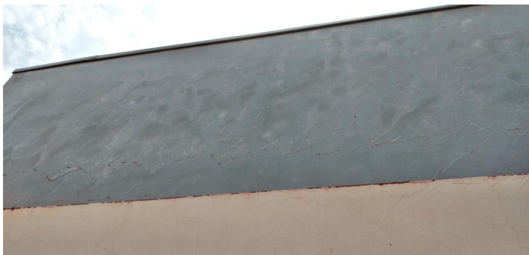
Foto 18: Fachada Posterior Danificada
