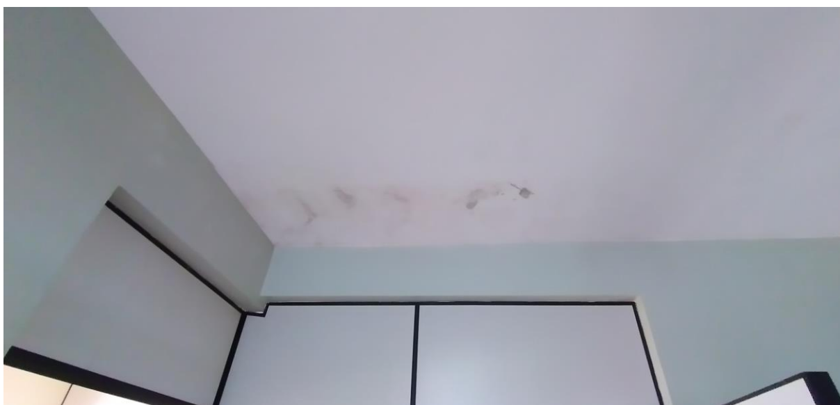
Foto 59: Laje da Área de Circulação Danificada
