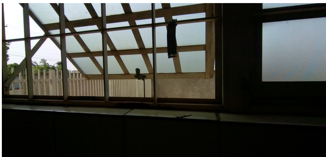
Foto 83: Janela do Banheiro Feminino Danificado
