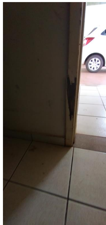
Foto 32: Guarnição da Porta Danificada
