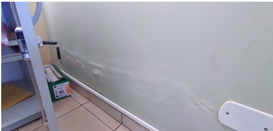
Foto 48: Parede da Área de Atendimento Danificada
