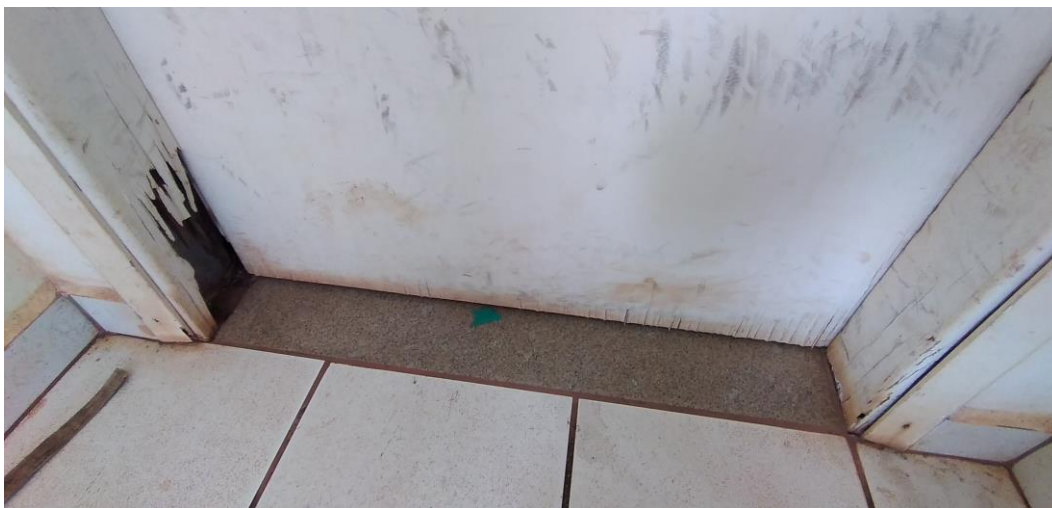
Foto 35: Porta e Guarnição Danificadas
