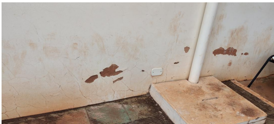
Foto 16: Fachada Posterior Danificada
