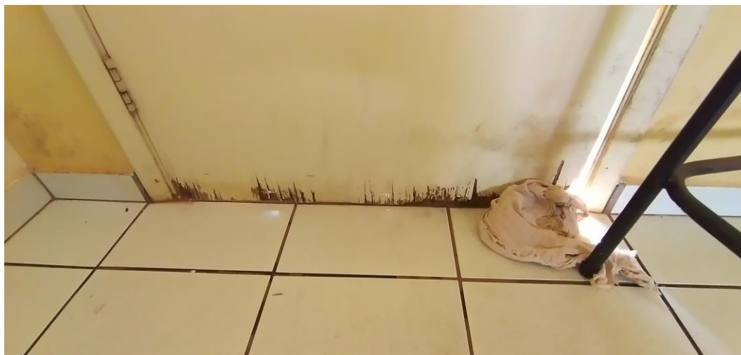
Foto 66: Porta de Acesso Externo Danificada
