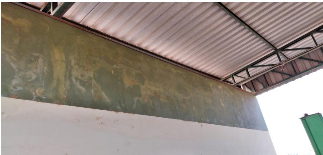
Foto 20: Parede da Área de Vistoria Danificada
