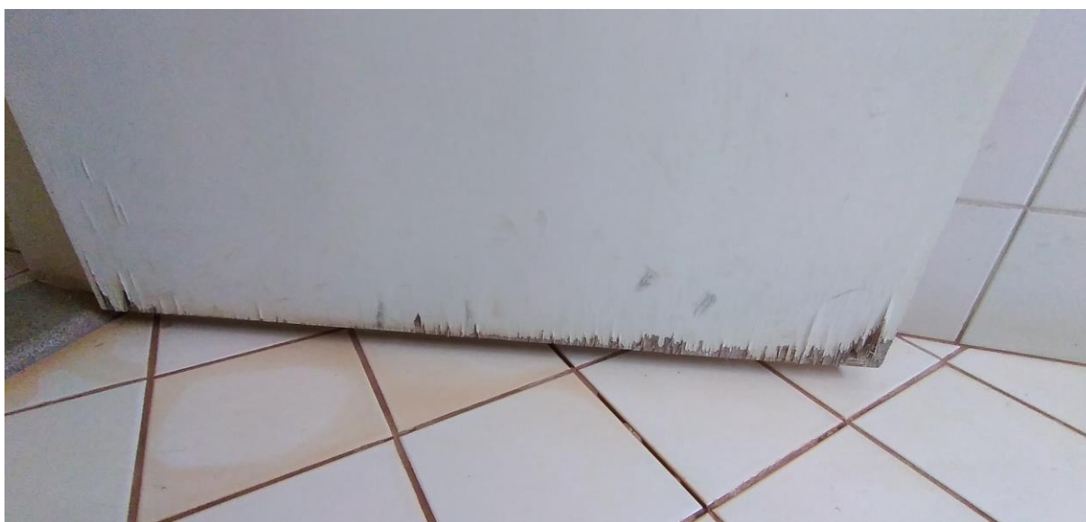
Foto 72: Porta do Banheiro Feminino Danificada
