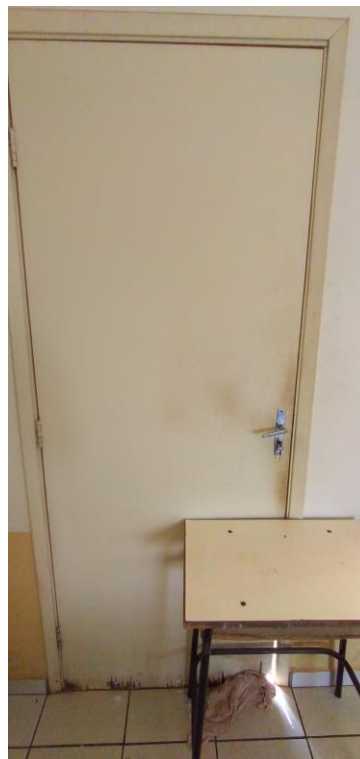
Foto 65: Porta de Acesso Externo Danificada
