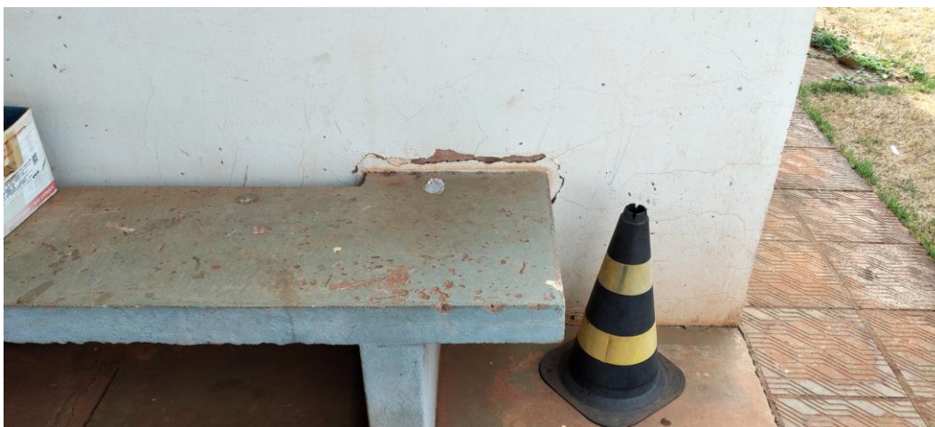
Foto 22: Banco de Concreto Danificado
