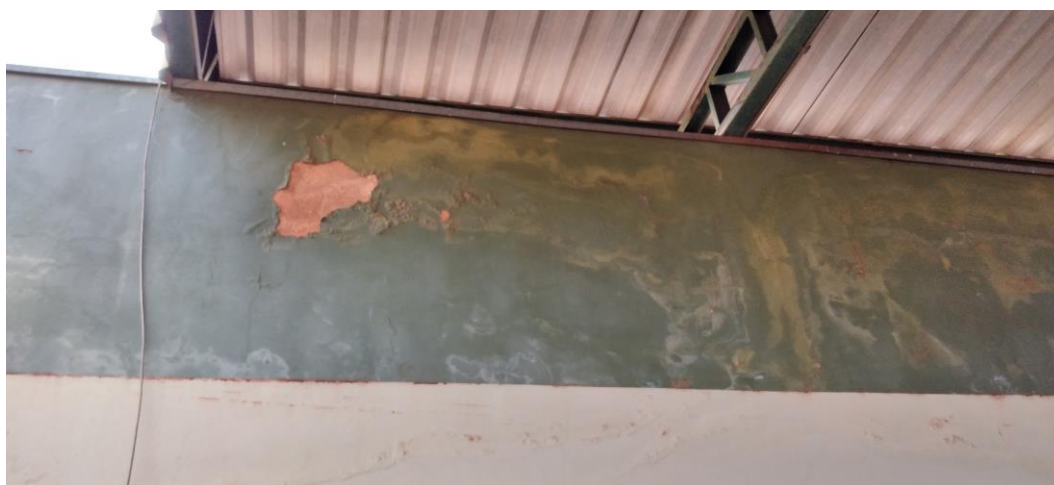
Foto 19: Parede da Área de Vistoria Danificada
