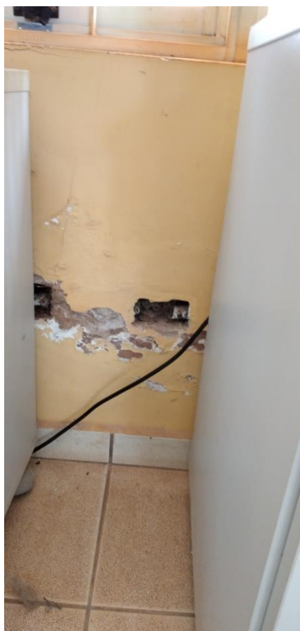
Foto 49: Parede da Área de Atendimento Danificada
