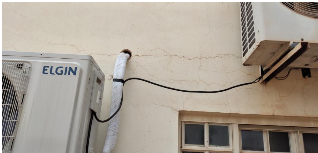
Foto17: Fachada Posterior Danificada
