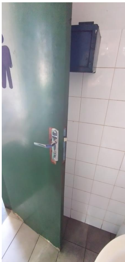
Foto 62: Maçaneta da Porta do Banheiro Masculino Danificada
