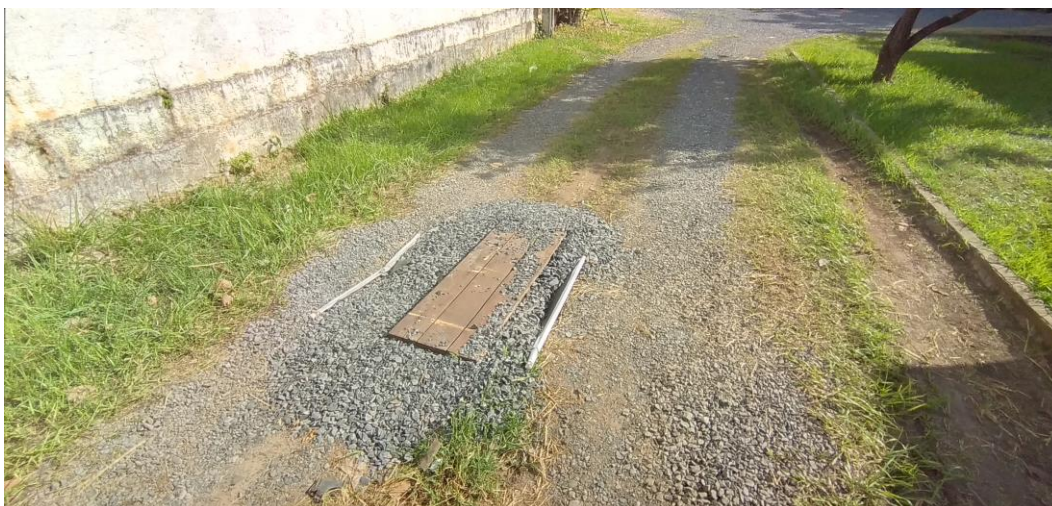
Foto 14: Sumidouro na entrada e acesso ao Pátio Interno afundando
