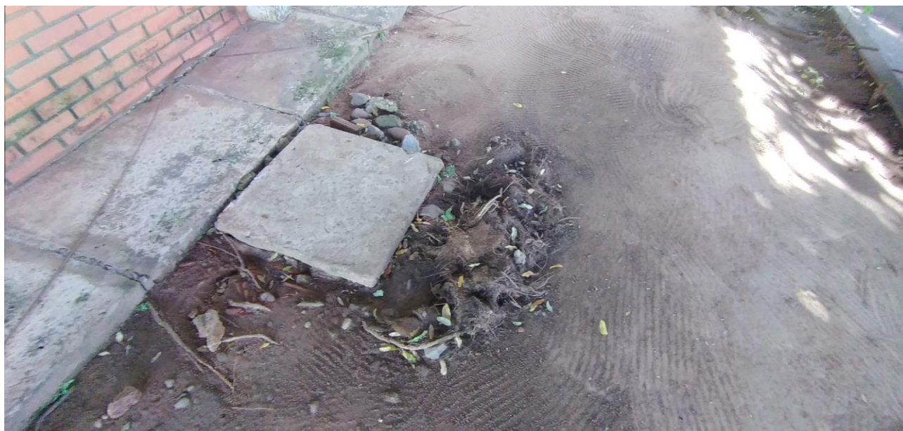
Foto 9: Caixa de Passagem Danificada
