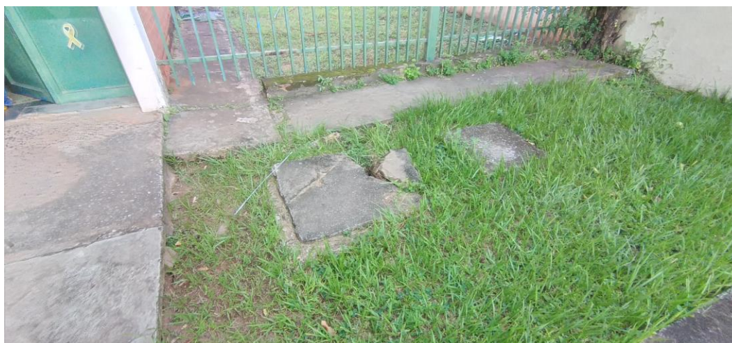
Foto 3: Jardim Frontal Danificado
