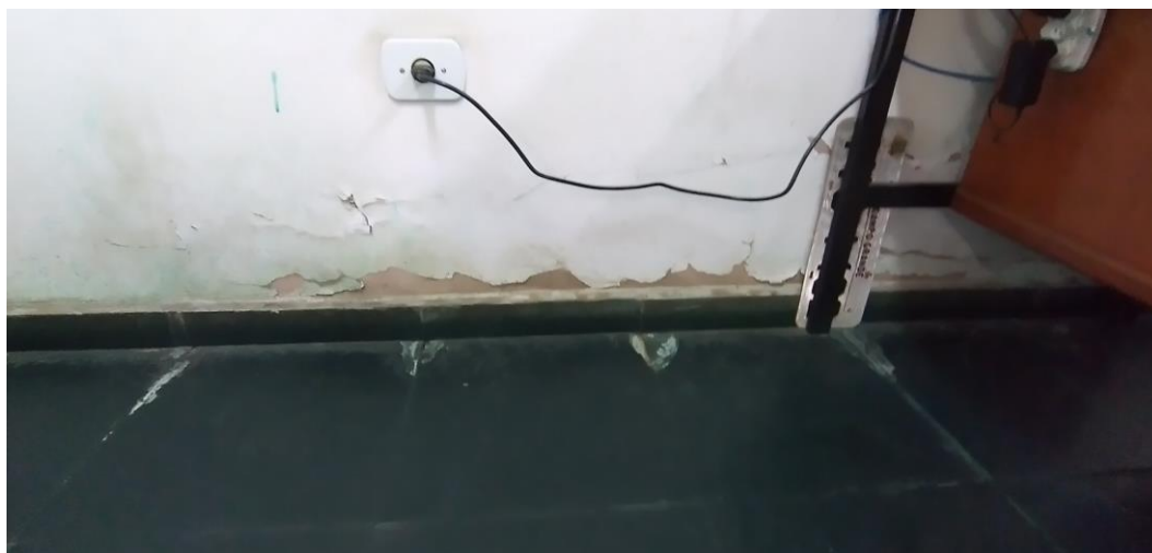
Foto 72: Parede do Administrativo Danificada
