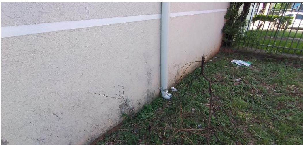
Foto 22: Pátio Interno Danificado
