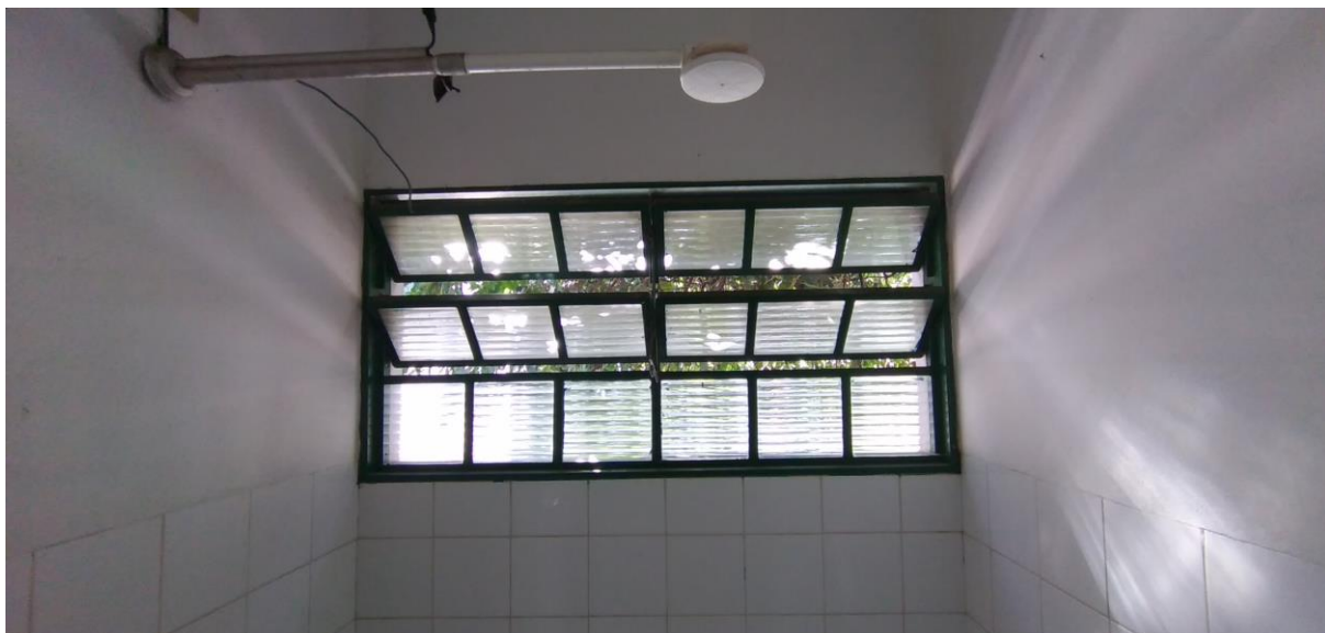
Foto 61: Janela do Banheiro Masculino
