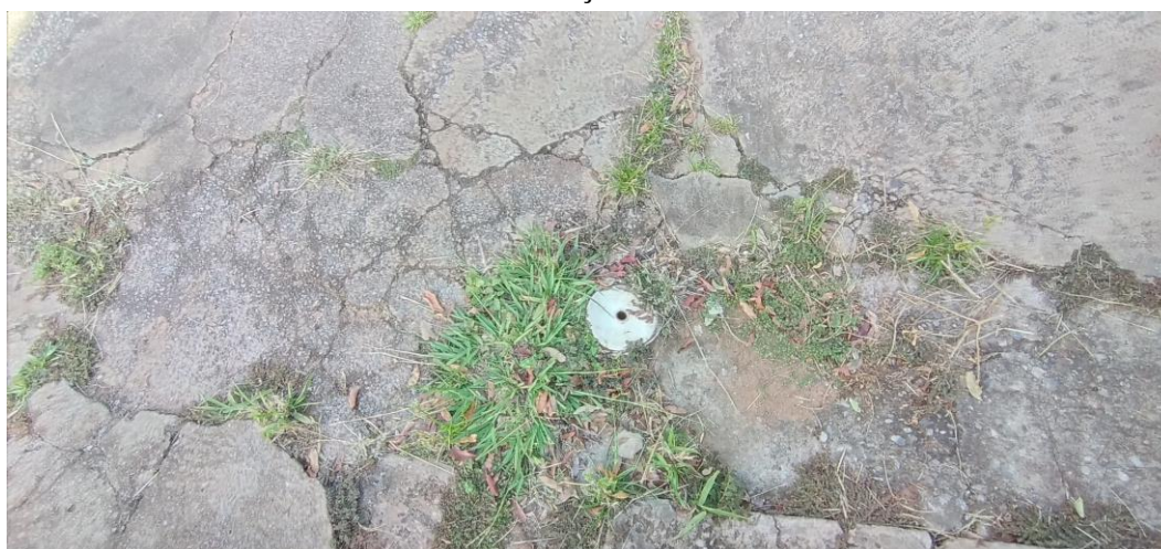
Foto 6: Calçada Externa Danificada
