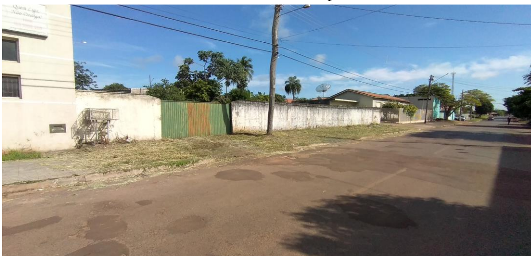
Foto 36: Fachada Posterior Externa, Portão de Acesso e Calçada Danificada
