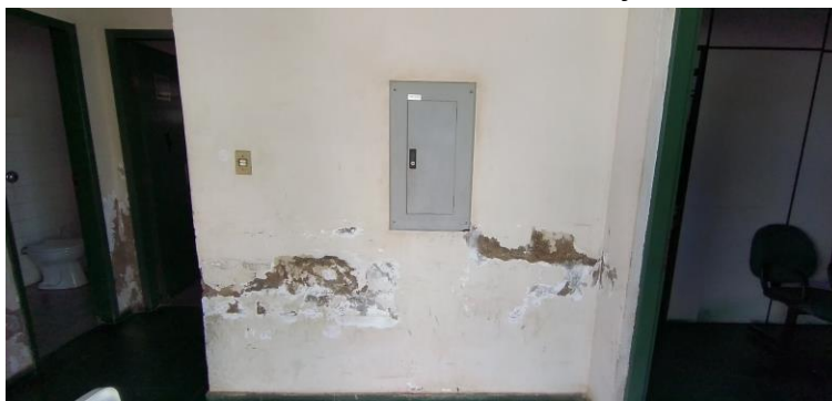
Foto 55: Parede da Área de Circulação Danificada
