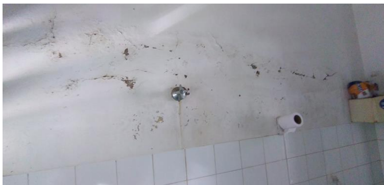
Foto 67: Parede do Banheiro Feminino Danificada
