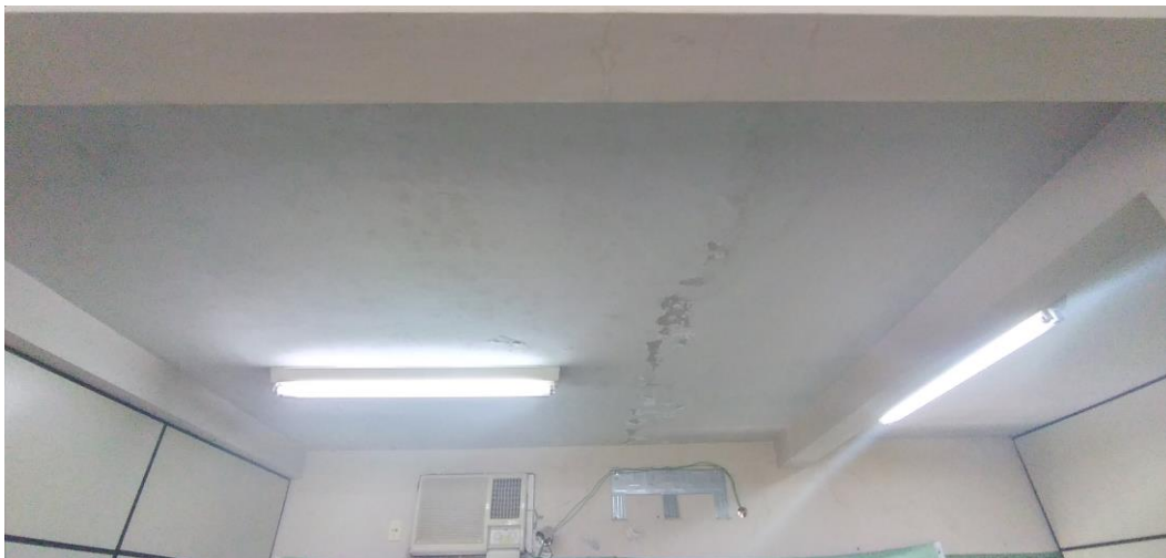
Foto 72: Laje da Área de Atendimento Danificada
