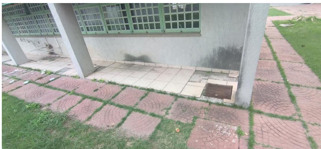
Foto 9: Piso da Calçada Externa Danificado
