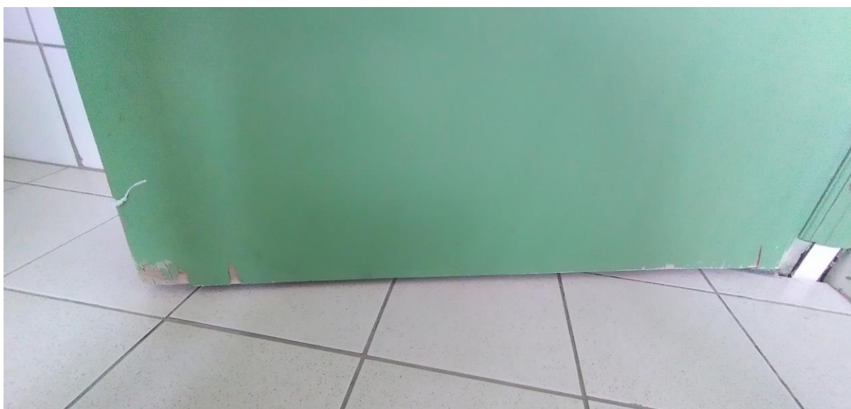
Foto 43: Porta do Banheiro Masculino Danificada
