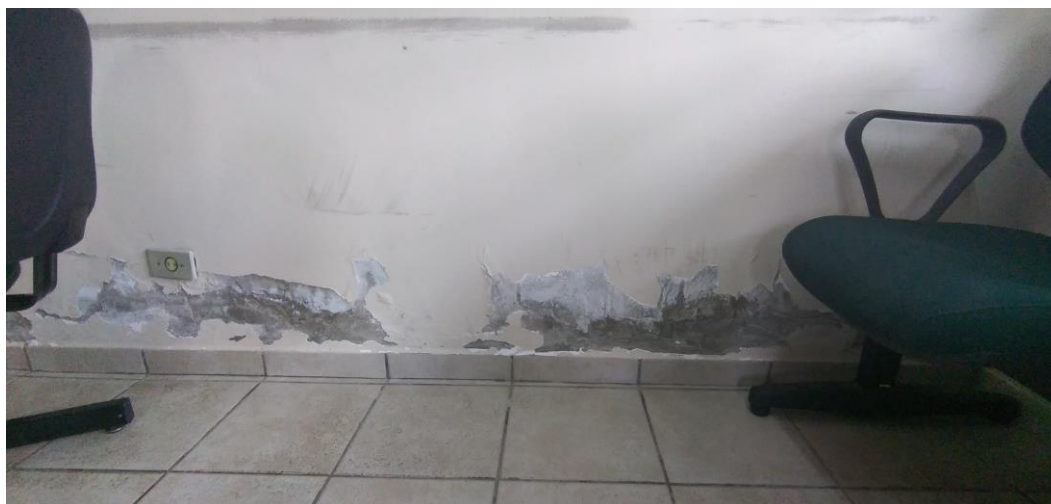
Foto 70: Parede da Área de Atendimento Danificada
