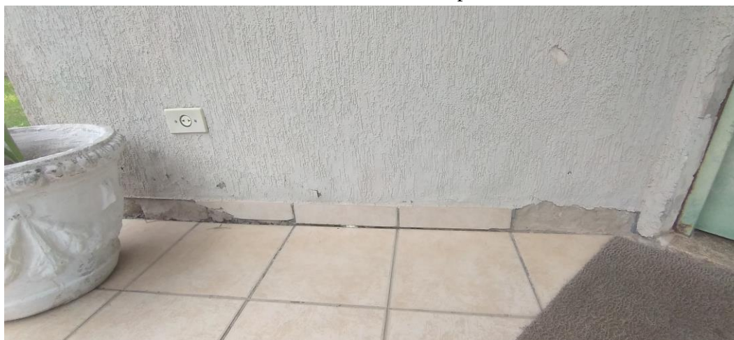
Foto 16: Parede e Piso da Entrada Principal Danificada
