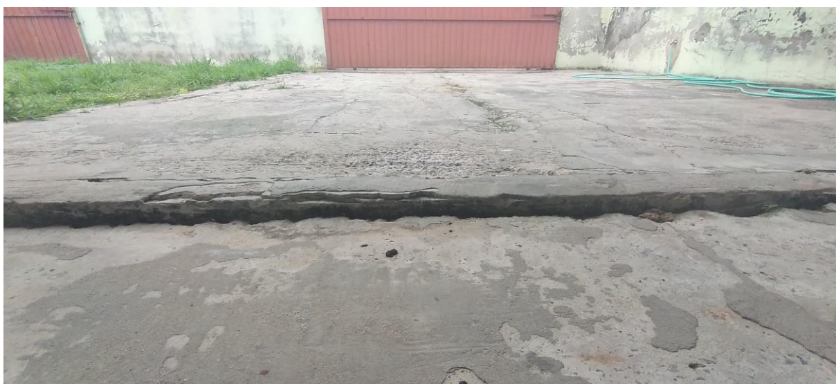
Foto 29: Calçada Interna Danificada
