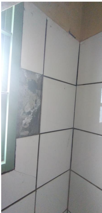
Foto 48: Azulejo do Banheiro Danificado
