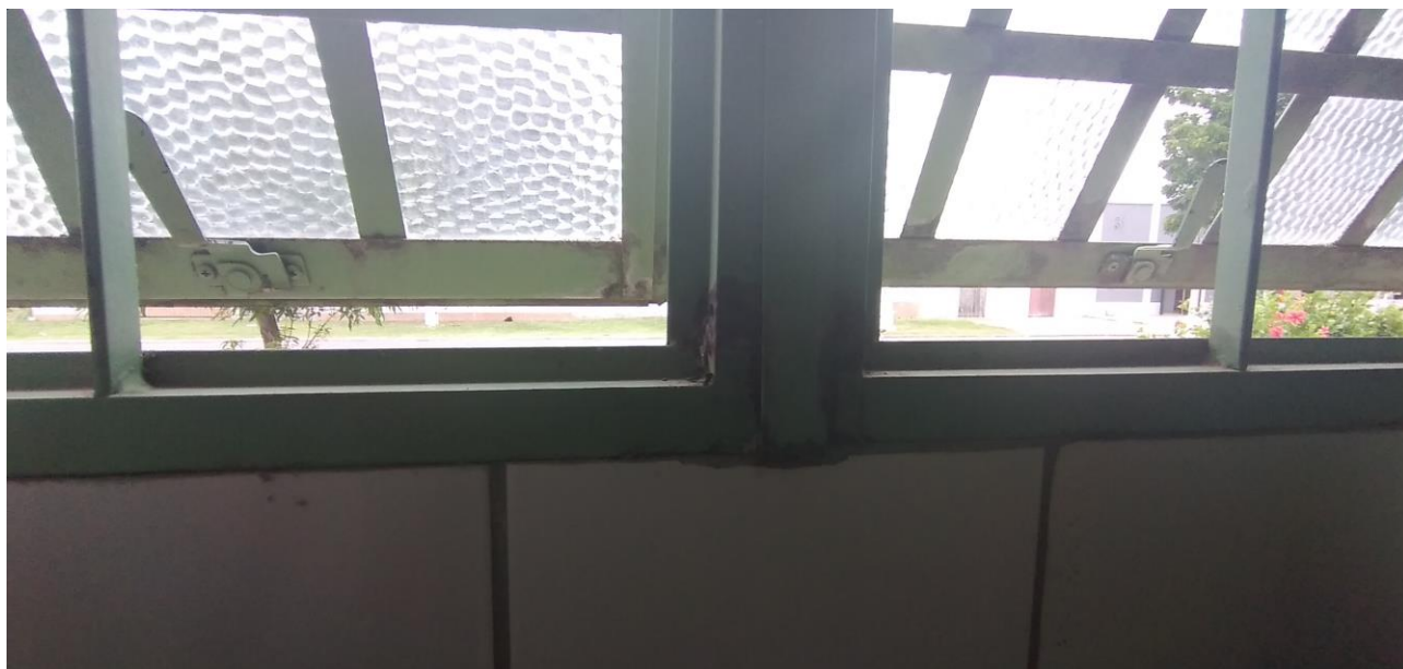
Foto 55: Janela do Banheiro Feminino Danificada
