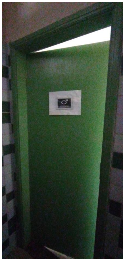
Foto 41: Porta Banheiro Masculino
