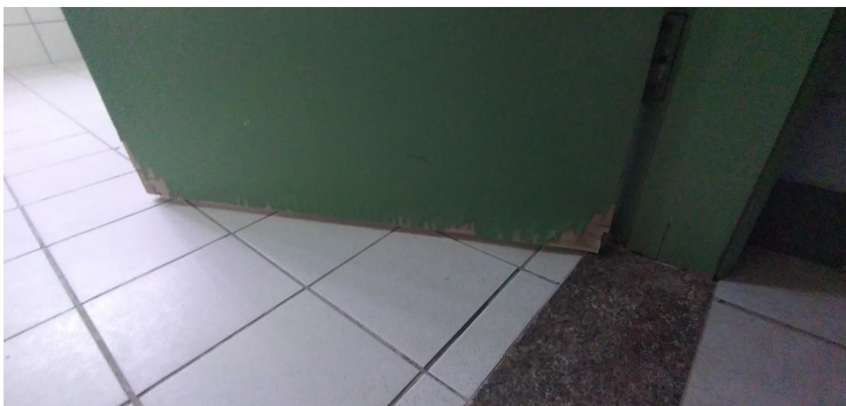
Foto 51: Porta do Banheiro Feminino Danificada
