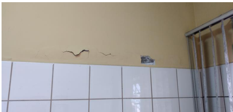
Foto 56: Parede do Banheiro Feminino Danificada
