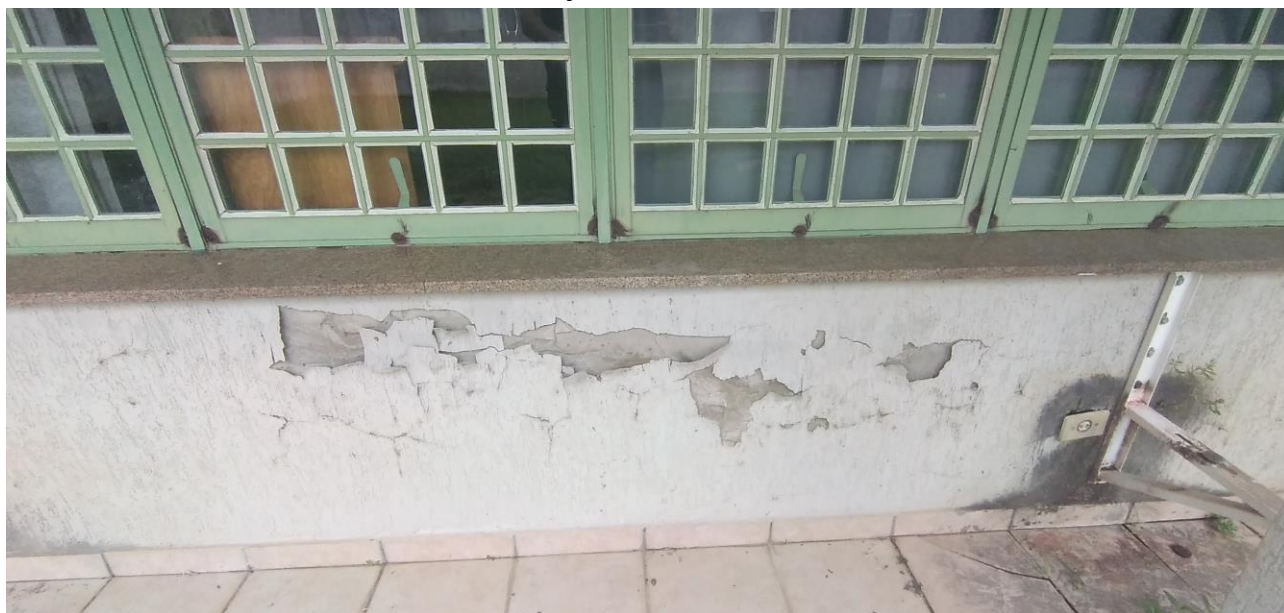
Foto 13: Parede do Corredor Lateral Danificada
