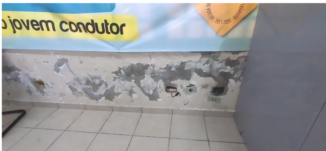
Foto 65: Parede do Administrativo Danificada
