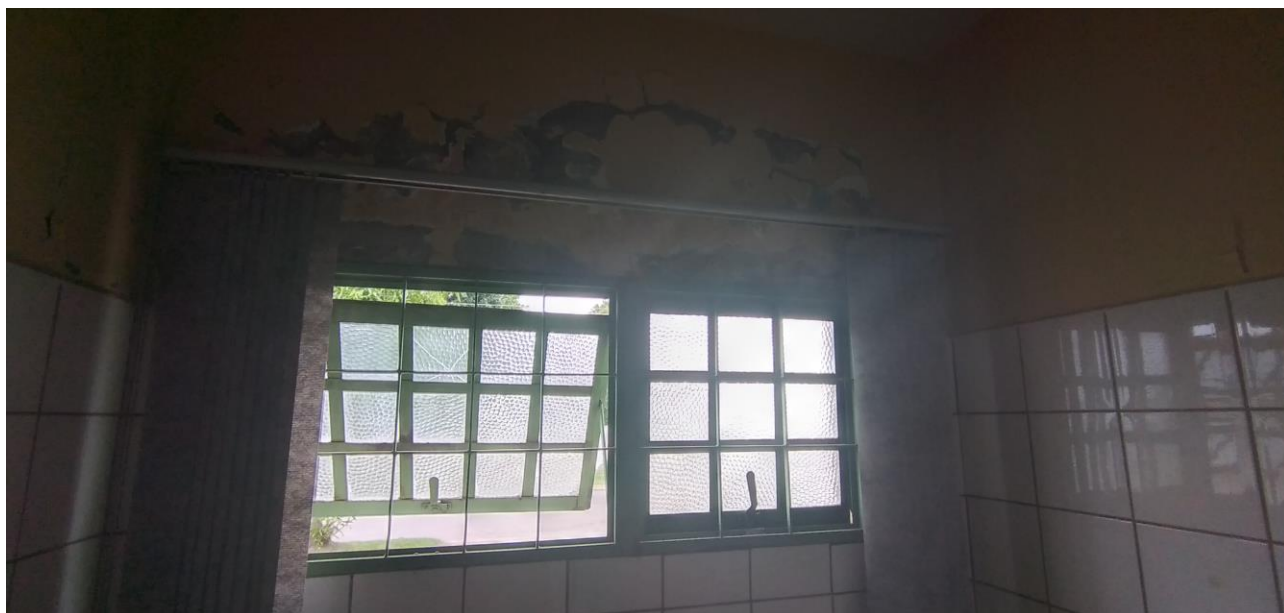
Foto 47: Janela e Parede do Banheiro Masculino Danificada
