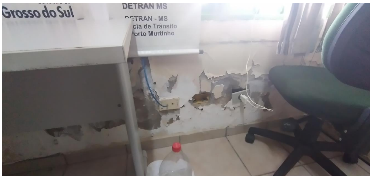
Foto 62: Parede da Sala do Gerente Danificada
