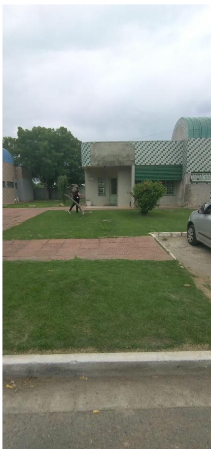
Foto 28: Marquise Frontal Danificada e Calçada Externa
