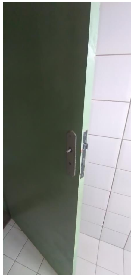
Foto 42: Maçaneta e Fechadura da Porta do Banheiro Masculino Danificadas
