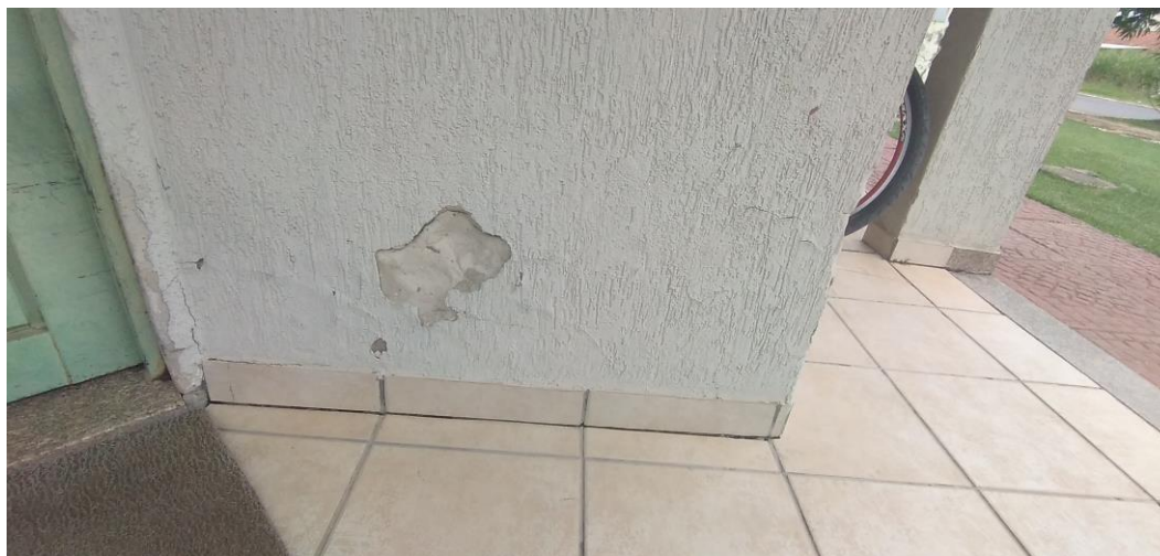
Foto 15: Parede do Acesso Principal Danificada
