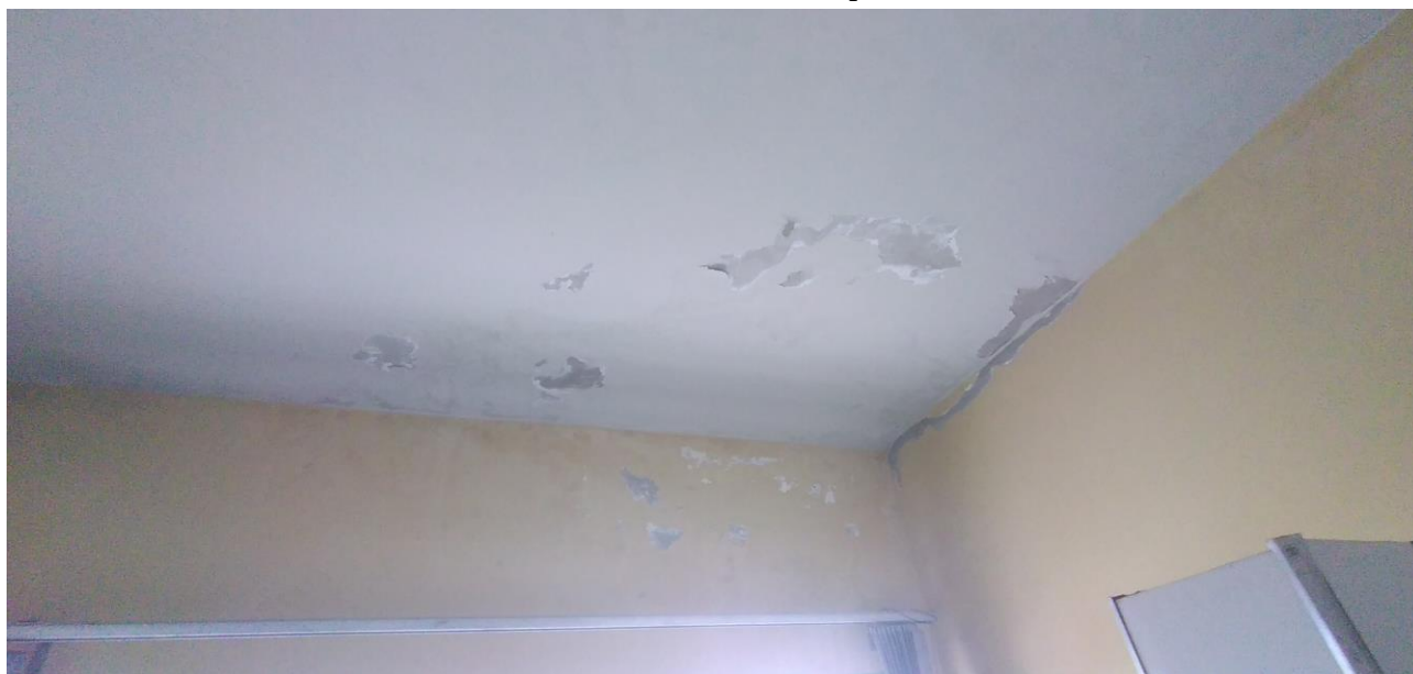
Foto 39: Parede e Laje da Copa Danificadas
