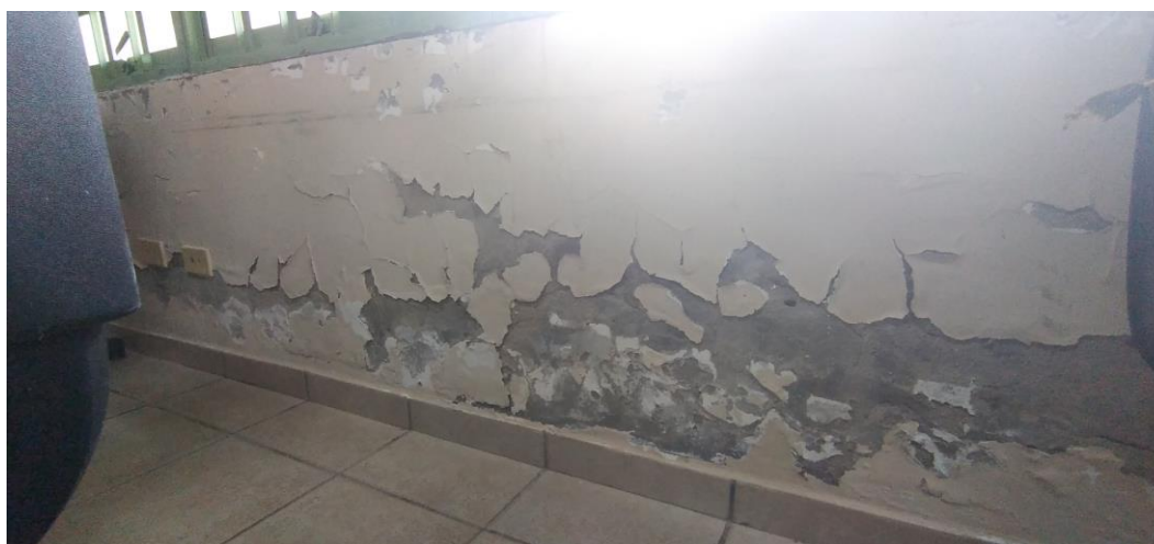
Foto 71: Parede da Área de Atendimento Danificada
