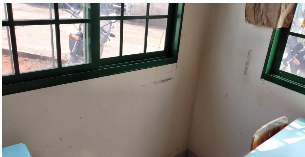
Foto 79: Parede da Sala de Exames Danificada
