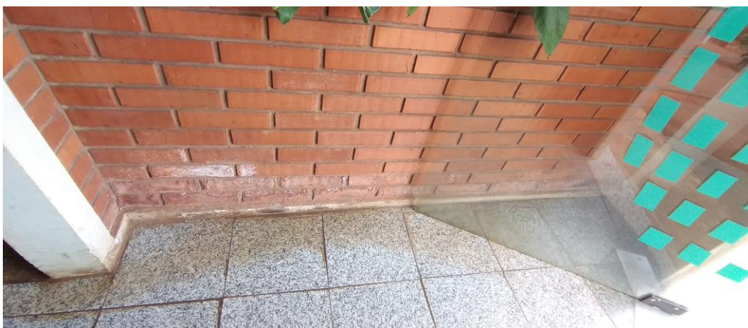
Foto 106: Parede da Entrada Principal Danificada
