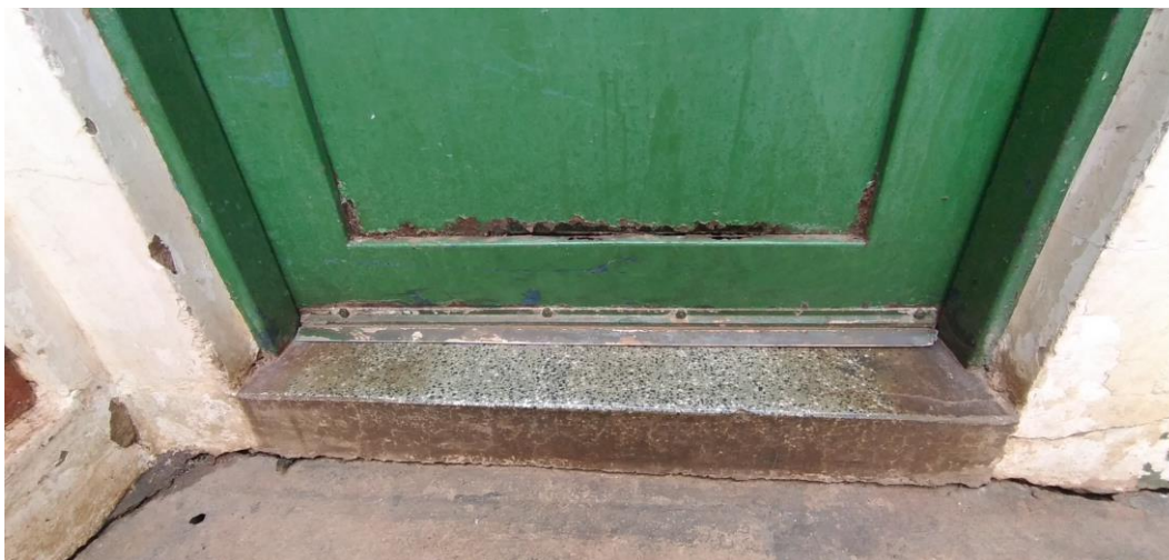
Foto 98: Porta de Acesso à Copa Danificada
