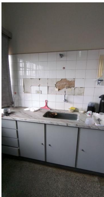
Foto 158: Bancada da Copa e Revestimento Danificados
