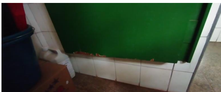
Foto 154: Porta do Sanitário Masculino Danificada
