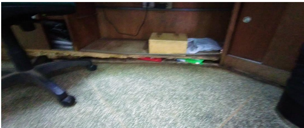
Foto 163: Balcão de Atendimento Danificado
