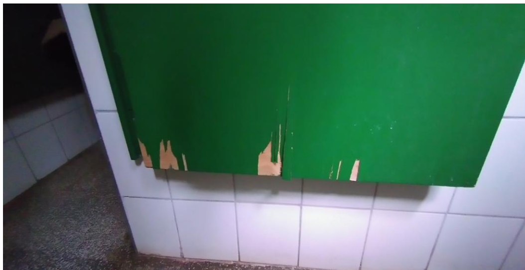
Foto 149: Porta da Cabine Danificada
