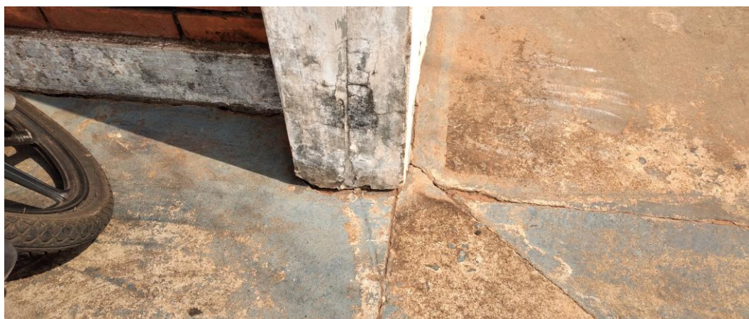
Foto 104 a: Encontro de Coluna com Calçada Externa Danificado
