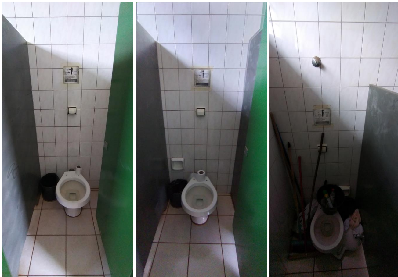
Foto 52, 53 e 54: Sanitários Masculinos Danificados
