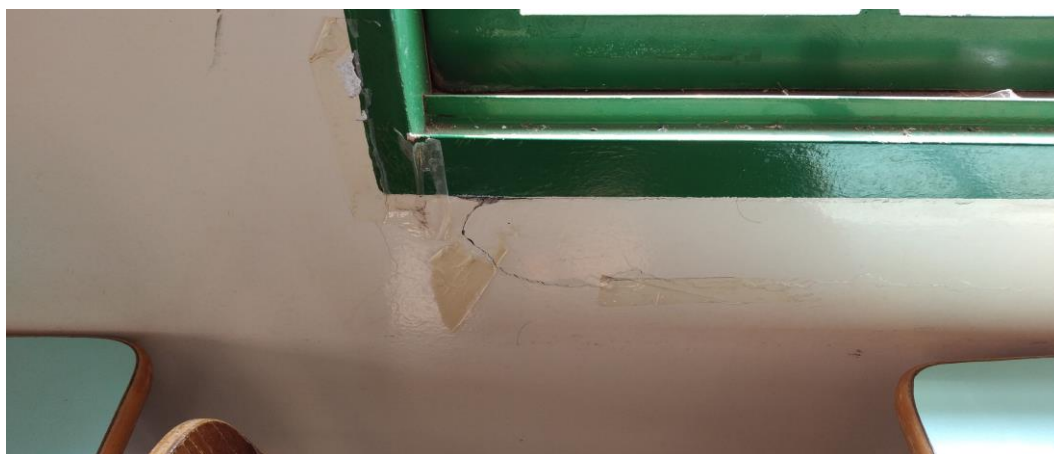
Foto 76: Parede da Sala de Exames Danificada
