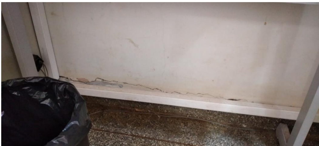
Foto 120: Parede da Sala de Digitação Danificada
