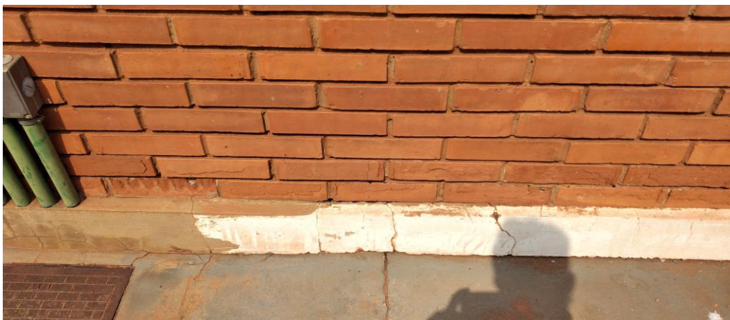
Foto 104 b: Fachada Frontal Danificada
