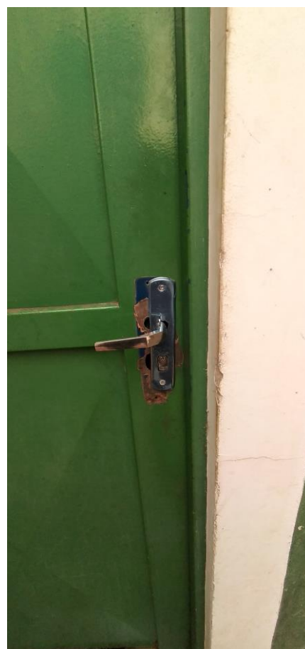
Foto 97: Maçaneta e Fechadura Danificadas
