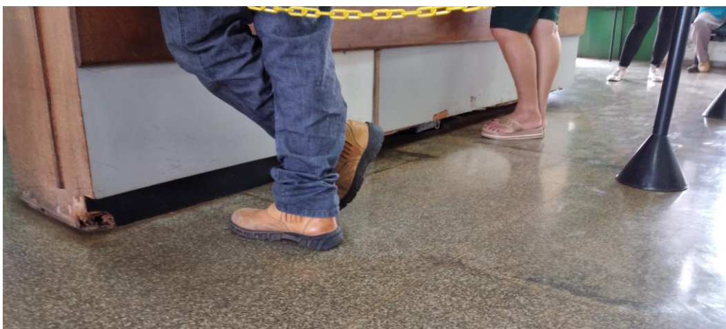
Foto 167: Balcão de Atendimento Danificado
