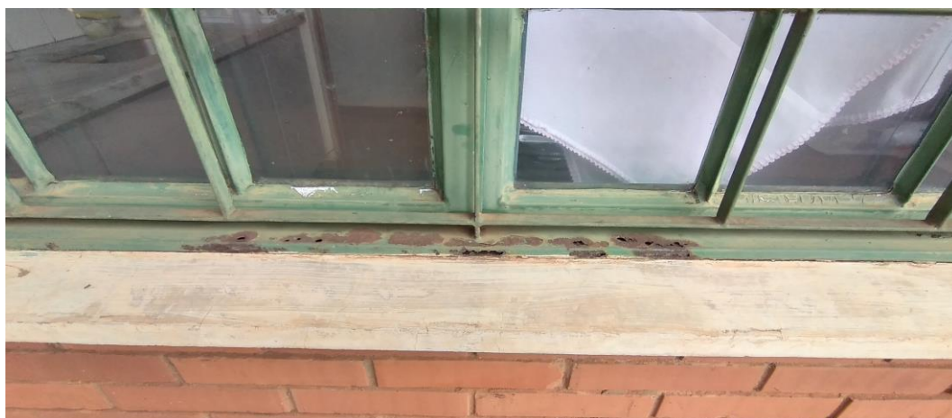
Foto 103: Janela na Fachada Frontal Danificada
