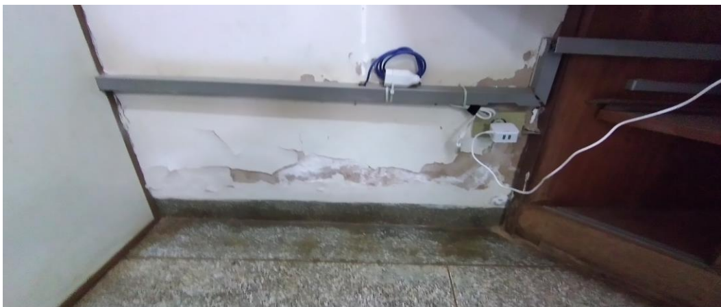
Foto 165: Parede da Área de Atendimento Danificada
