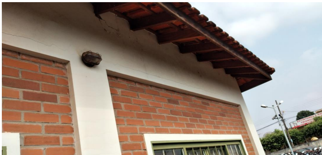
Foto 37: Parede Externa da Edificação Anexa ao Prédio Principal Danificada
