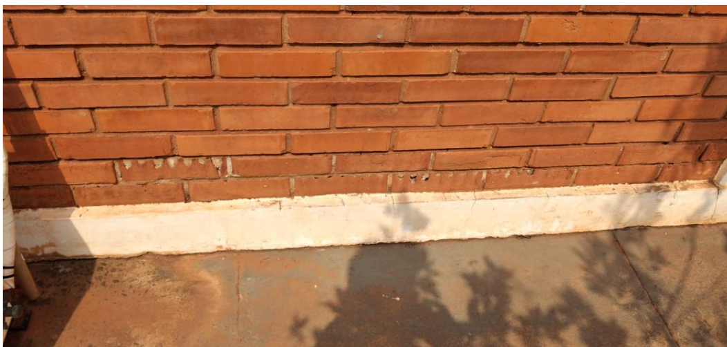
Foto 105: Fachada Frontal Danificada
