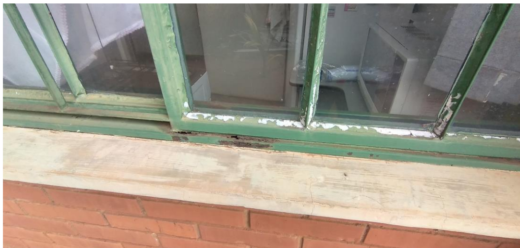
Foto 102: Janela na Fachada Frontal Danificada
