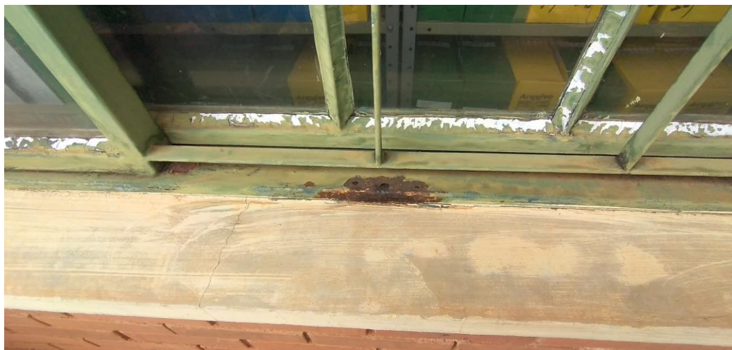
Foto 90: Janela da Fachada Posterior Danificada
