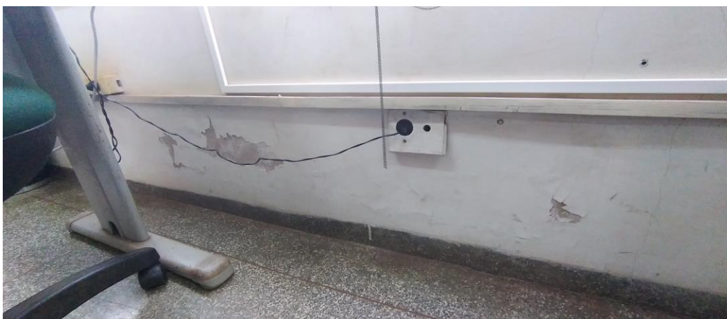
Foto 131: Parede da Sala do Gerente Danificada
