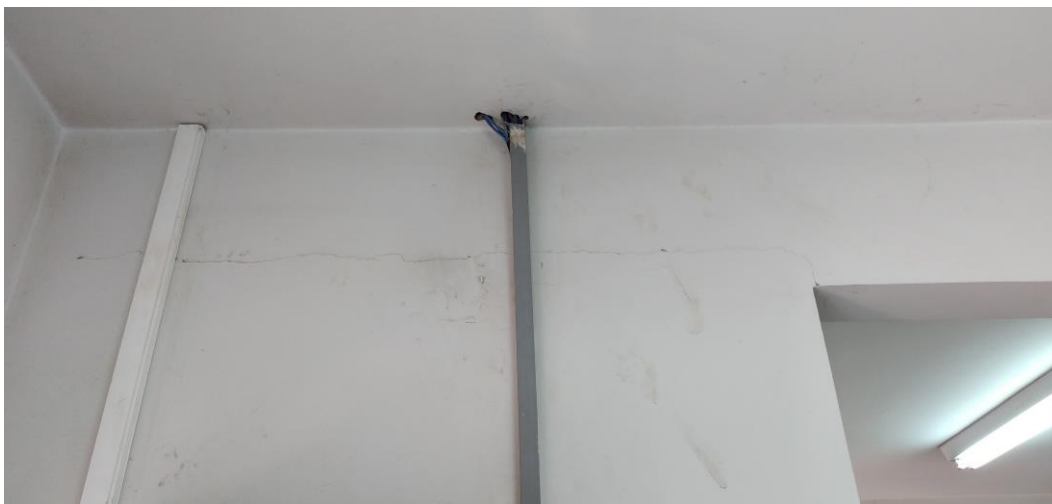
Foto 118: Parede da Sala de Digitação Danificada
