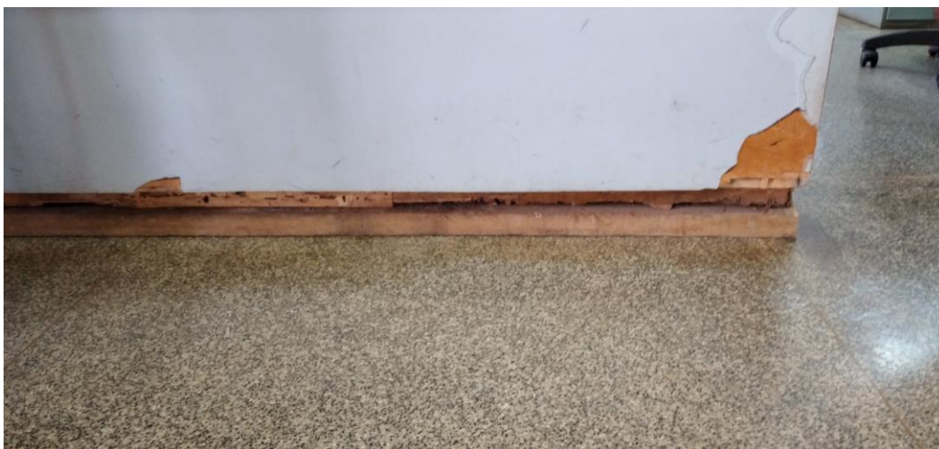
Foto 166: Balcão de Atendimento Danificado
