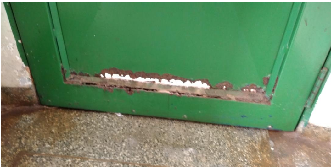
Foto 162: Porta de Acesso à Área de Serviço Danificada
