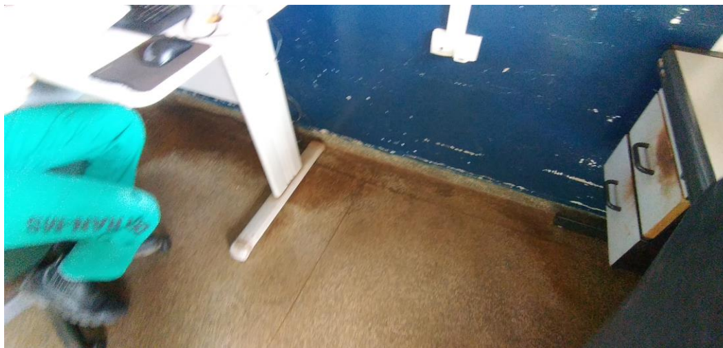
Foto 27: Parede da Sala de Vistoria Danificada
