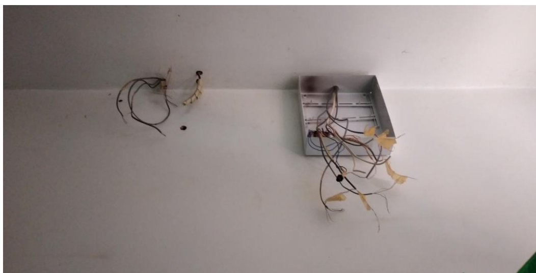
Foto 145: Instalação Elétrica Desativada
