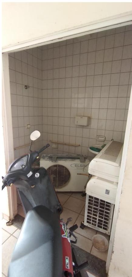
Foto 57: Banheiro PCD Danificado
