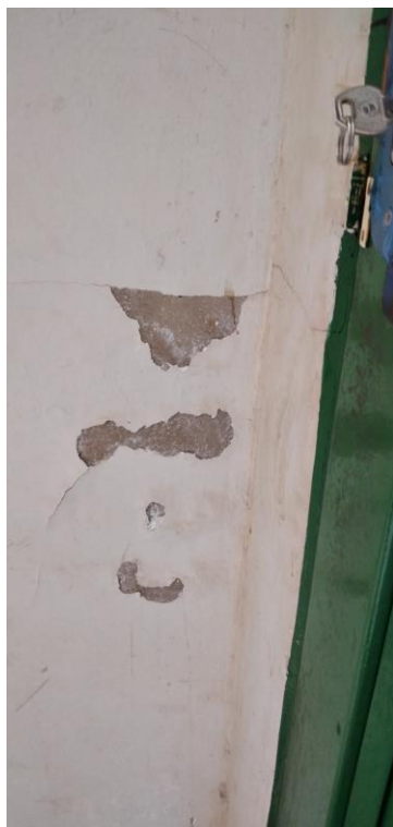
Foto 156: Parede Da Copa Danificada
