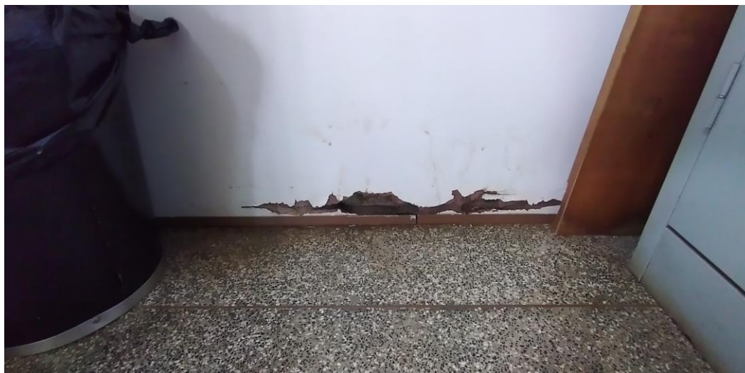
Foto 138: Divisória de Madeira Naval Danificada
