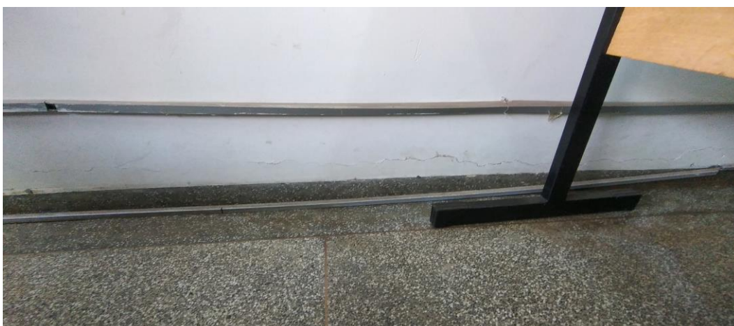
Foto 130: Parede da Sala do Gerente Danificada
