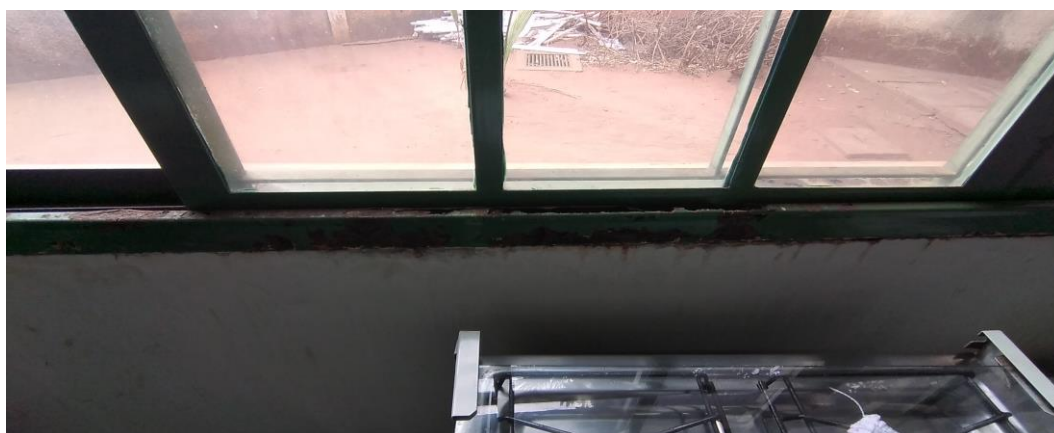
Foto 160: Janela da Copa Danificada
