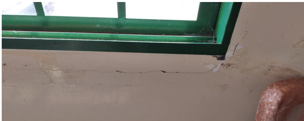
Foto 77: Parede da Sala de Exames Danificada
