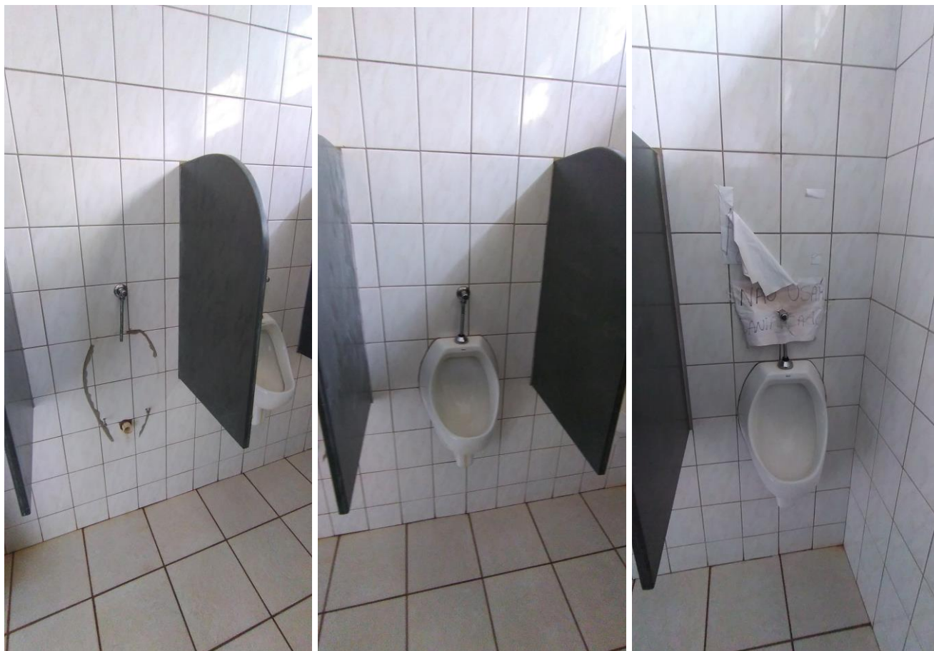
Fotos 48, 49 e 50: Mictórios Danificados
