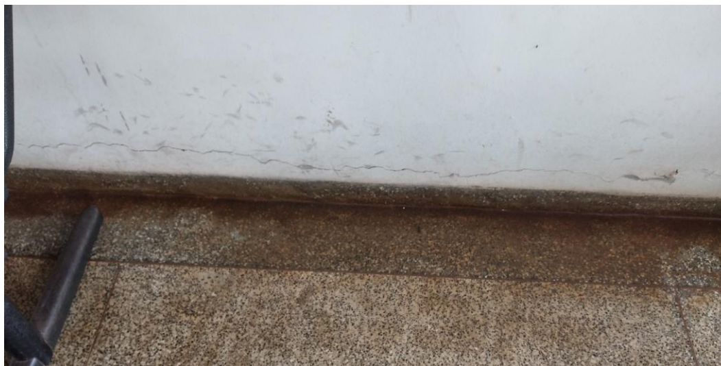
Foto 121: Parede da Sala de Digitação Danificada
