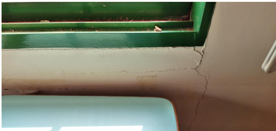
Foto 75: Parede da Sala de Exames Danificada
