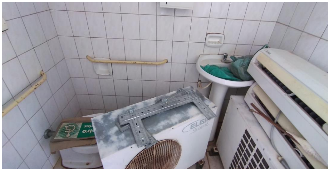
Foto 59: Banheiro PCD Danificado
