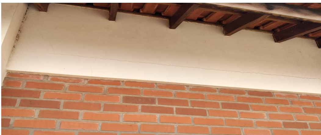
Foto 36: Parede Externa da Edificação Anexa ao Prédio Principal Danificada
