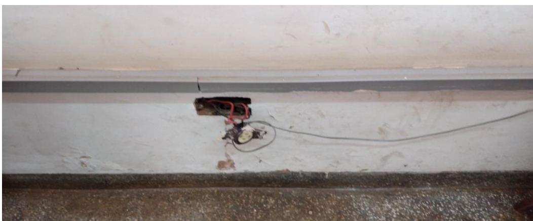
Foto 119: Tomada e Parede da Sala de Digitação Danificadas
