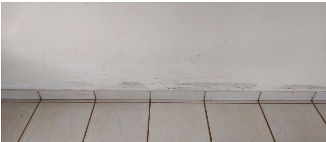
Foto 80: Parede da Sala de Exames Danificada
