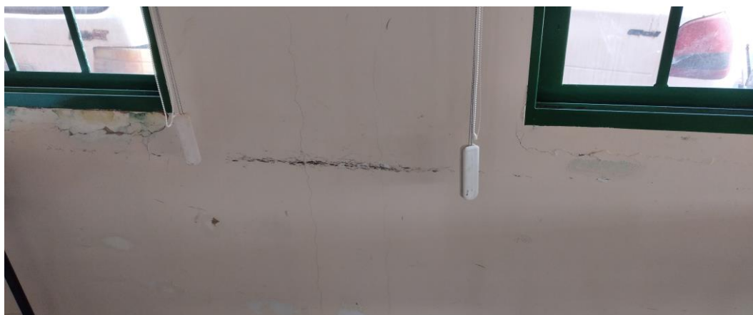
Foto 78: Parede da Sala de Exames Danificada
