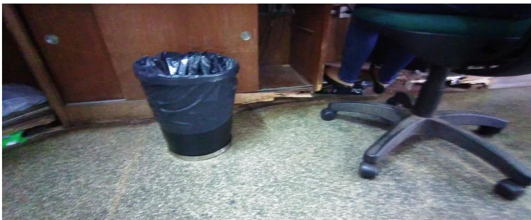
Foto 164: Balcão de Atendimento Danificado
