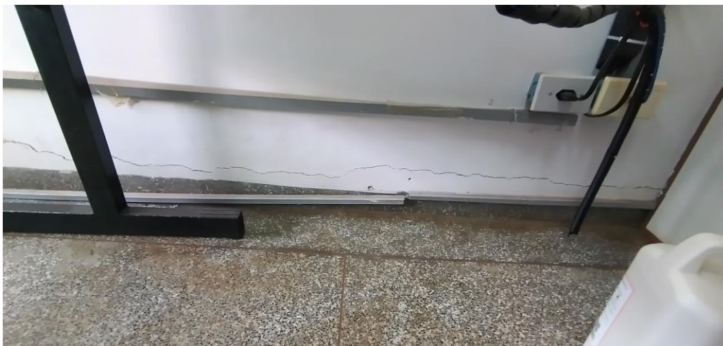
Foto 129: Parede da Sala do Gerente Danificada
