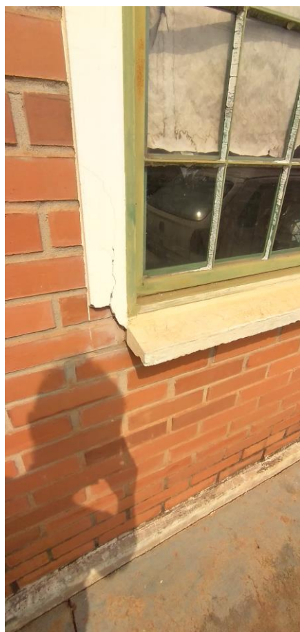
Foto 38: Moldura da Janela Danificada
