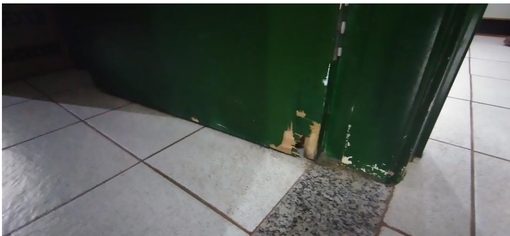
Foto 53: Porta do Arquivo Danificada
