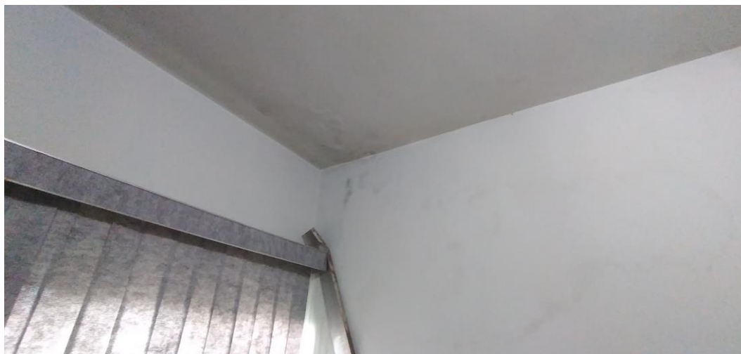
Foto 58: Laje do Arquivo Danificada
