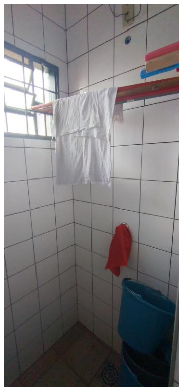
34 Foto 39: Banheiro Masculino Danificado
