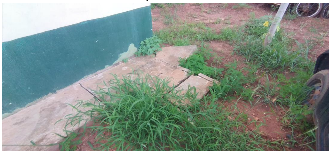
Foto 26: Calçada Interna Danificada
