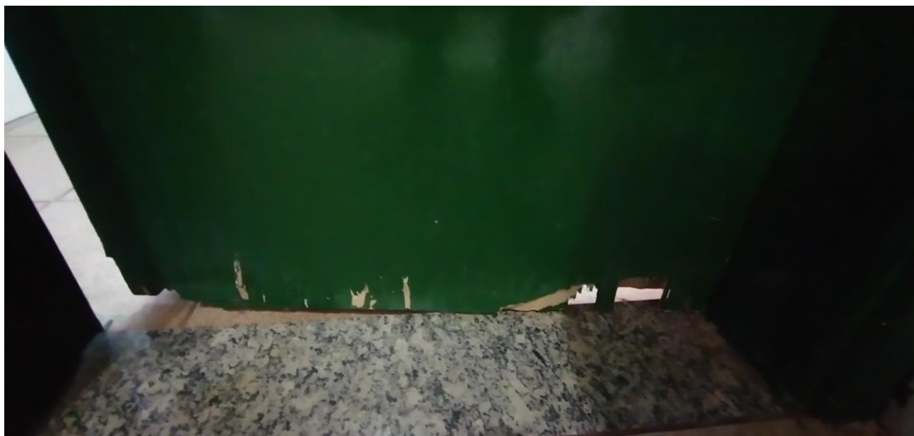
Foto 43: Porta do Banheiro Feminino Danificado
