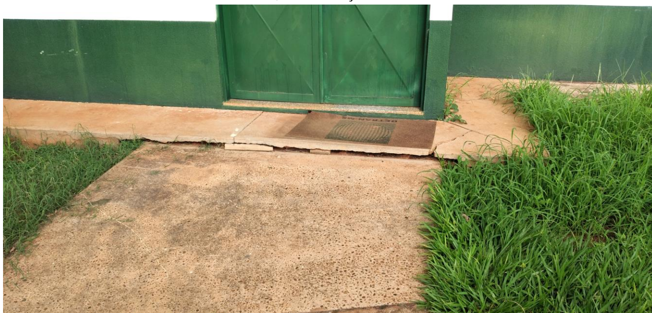
Foto 7: Calçada Interna Danificada
