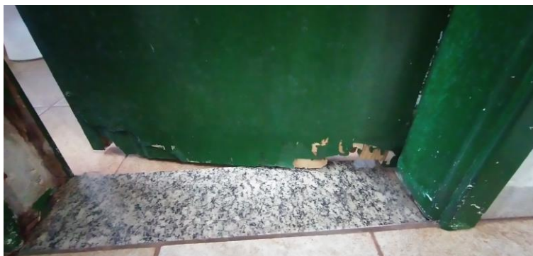
Foto 36: Porta do Banheiro Masculino Danificado
