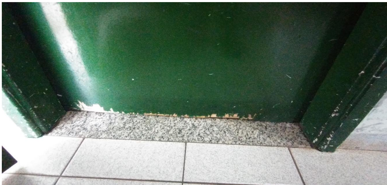
Foto 48: Porta da Sala de Vistoria Danificada
