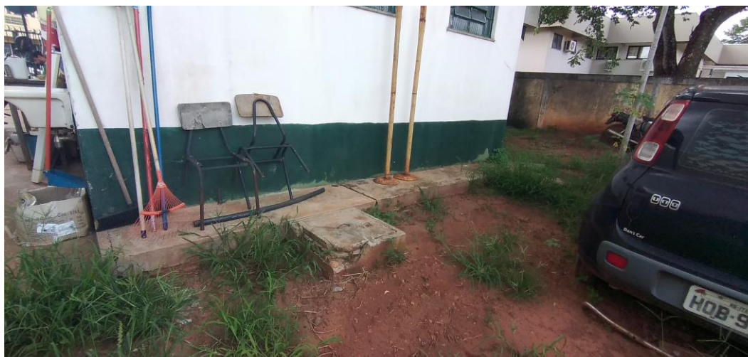
Foto 25: Calçada Interna Danificada
