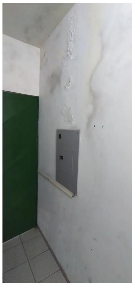
Foto 50: Parede da Área de Circulação Danificada
