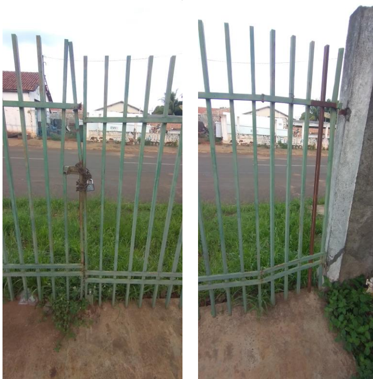
Foto 21 e 22: Portão de Acesso ao Pátio Danificado
