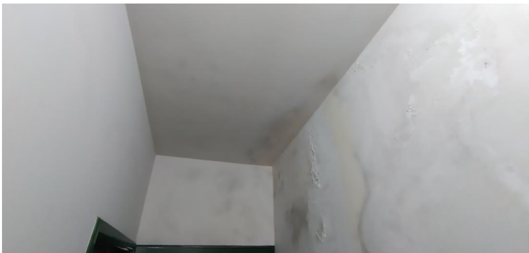
Foto 51: Laje da Área de Circulação Danificada
