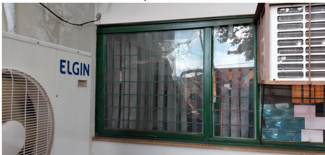
Foto 29: Janela da Fachada Posterior Danificada
