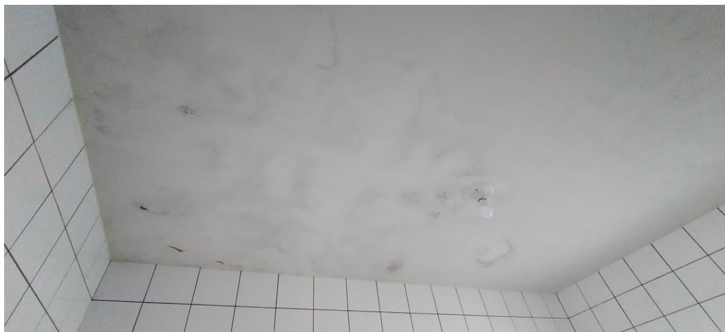
Foto 69: Laje da Copa Danificada
