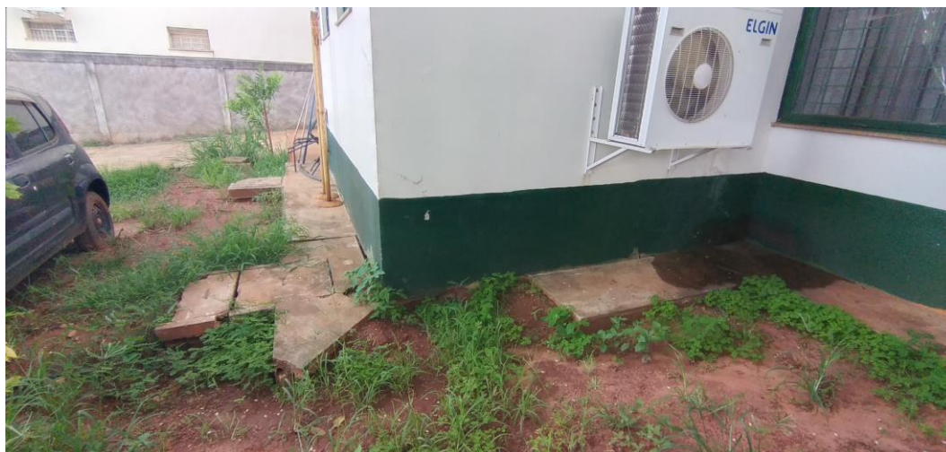
Foto 28: Calçada Interna Danificada
