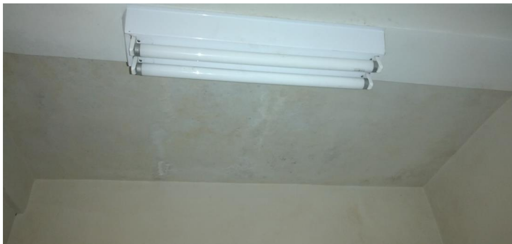
Foto 95: Teto Banheiro de deficientes
