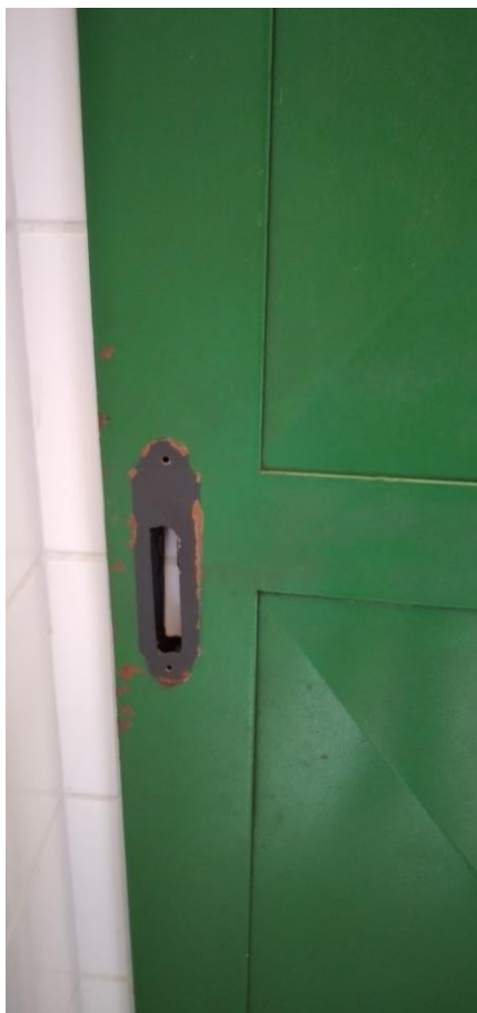
Foto 92: Fechadura porta banheiro feminino
