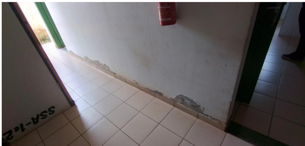
Foto 75: Parede corredor interno
