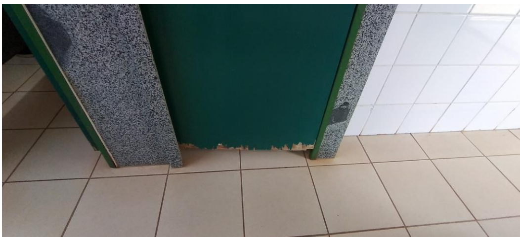
Foto 110: Porta sanitário banheiro masculino
