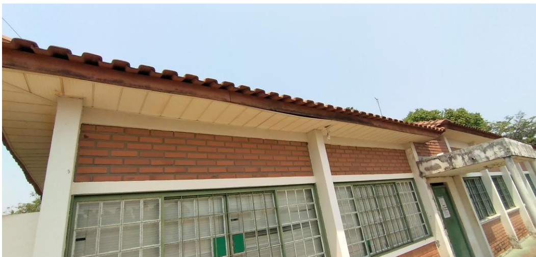
Foto 21: Forro externo frontal
