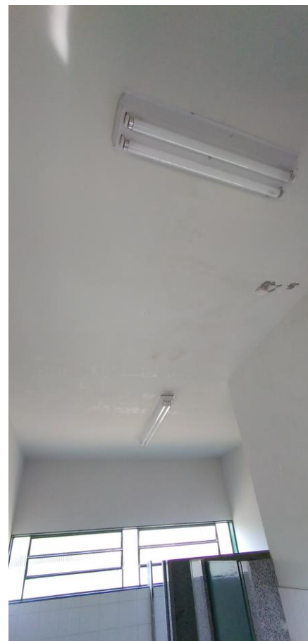
Foto 102: Teto banheiro masc
