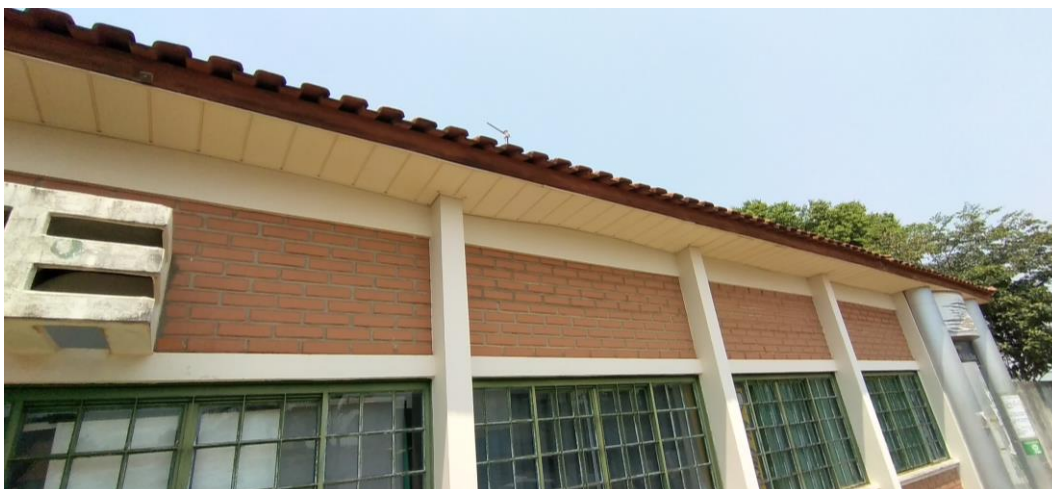
Foto 22: Forro externo frontal
