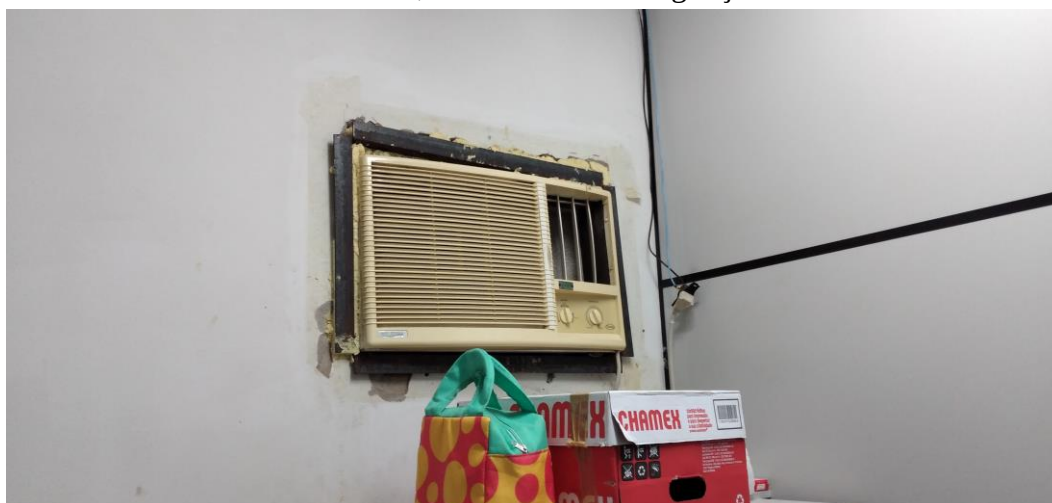
Foto 30: Ar condicionado sala de digitação
