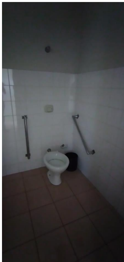
Foto 97: Sanitário banheiro deficientes
