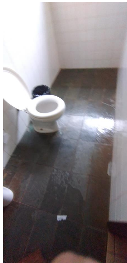
Foto 51: Chão banheiro feminino
