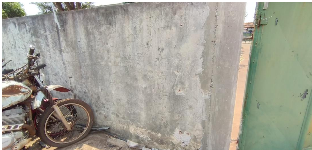
Foto 166: Muro ao lado do portão interno de acesso ao Pátio para carros apreendidos
