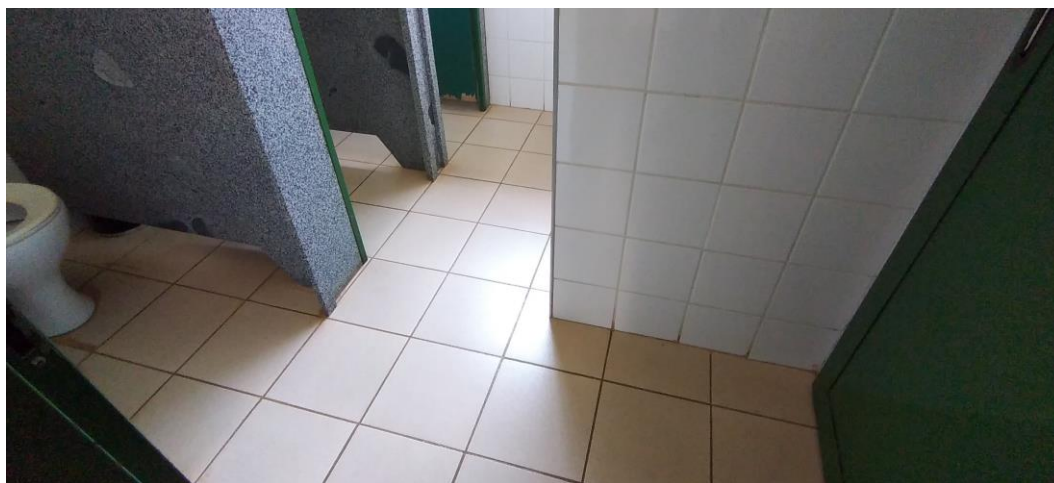
Foto 91: Chão banheiro feminino
