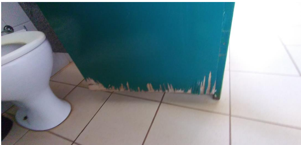
Foto 109: Porta sanitário banheiro masculino
