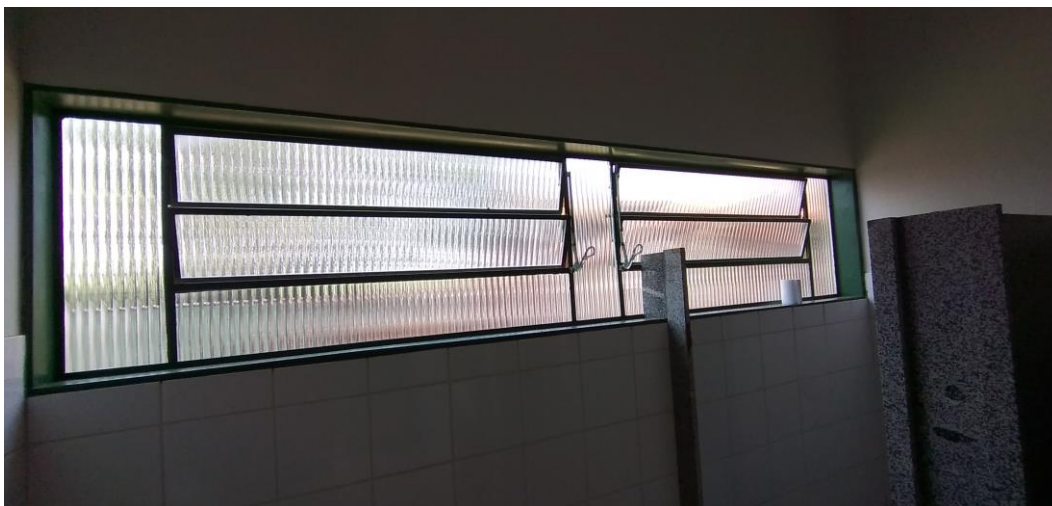
Foto 111: Janela banheiro masculino
