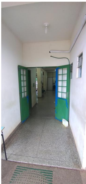
Foto 126: Porta de Acesso a Área de Vistoria Danificada
