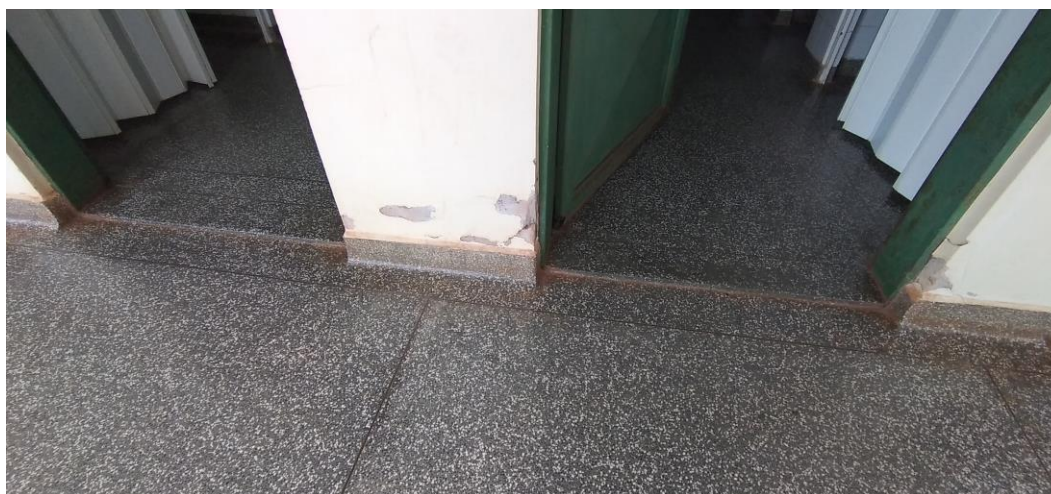
Foto 78: Parede da Área de Acesso aos Banheiros Danificada
