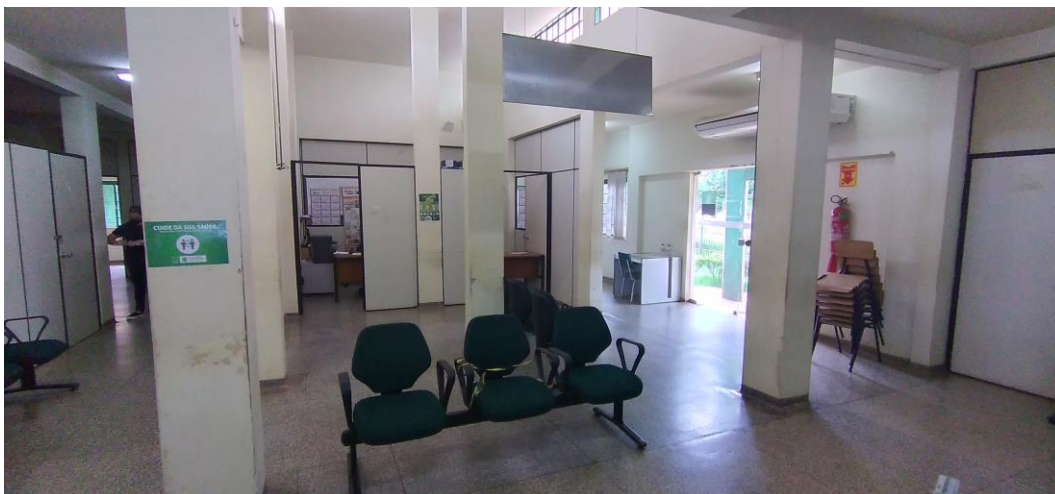
Foto 134: Área de Espera com Colunas Danificadas
