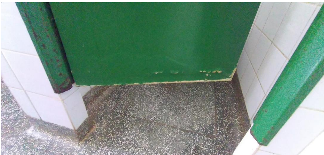
Foto 93: Porta do Sanitário Masculino Danificada
