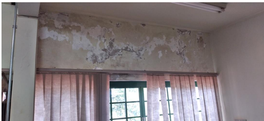
Foto 169: Parede da Sala de Atendimento Danificada
