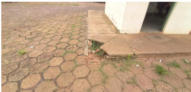
Foto 31: Calçada da Guarita Danificada
