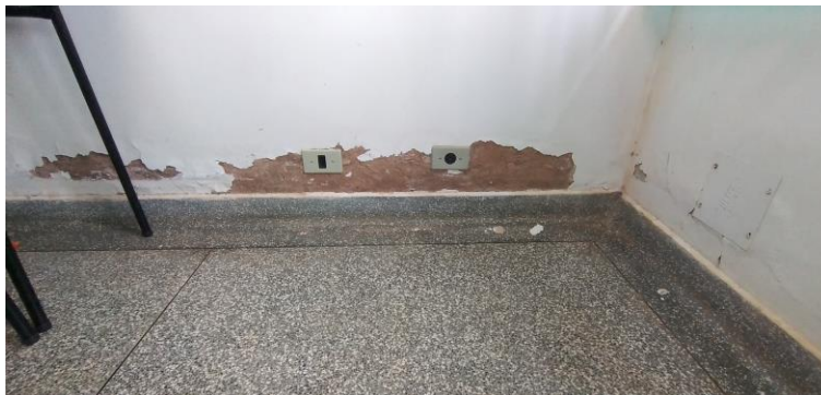
Foto 58: Parede da Sala de Aula Danificado
