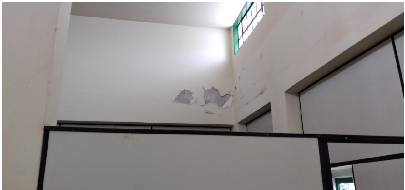
Foto 163: Parede da Sala de Multas Danificada
