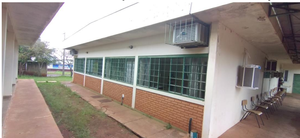
Foto 115: Fachada Lateral do Bloco Principal com Calçada e Beiral Danificados
