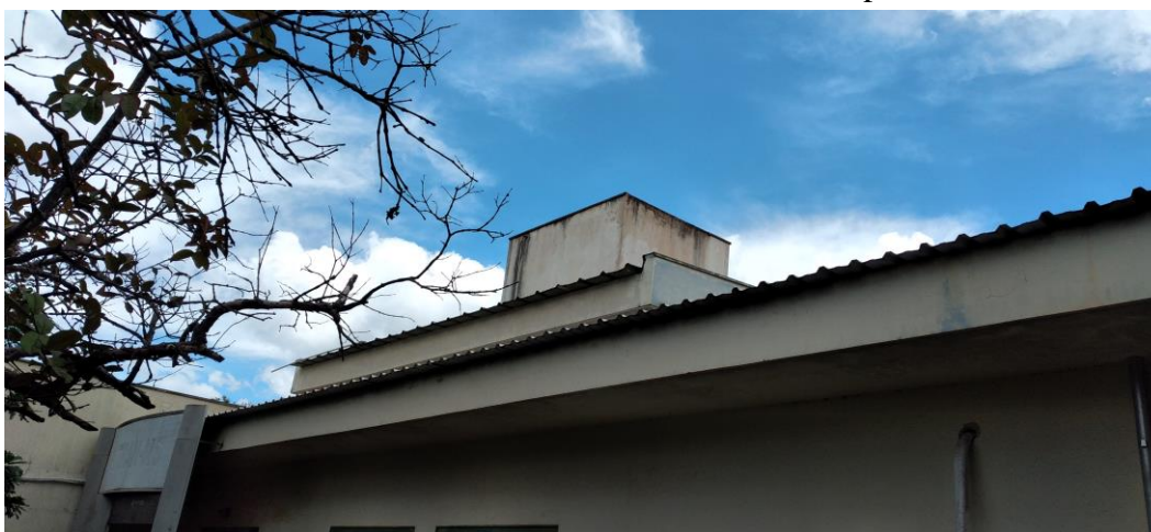
Foto 118: Volume da Caixa de Água Danificado
