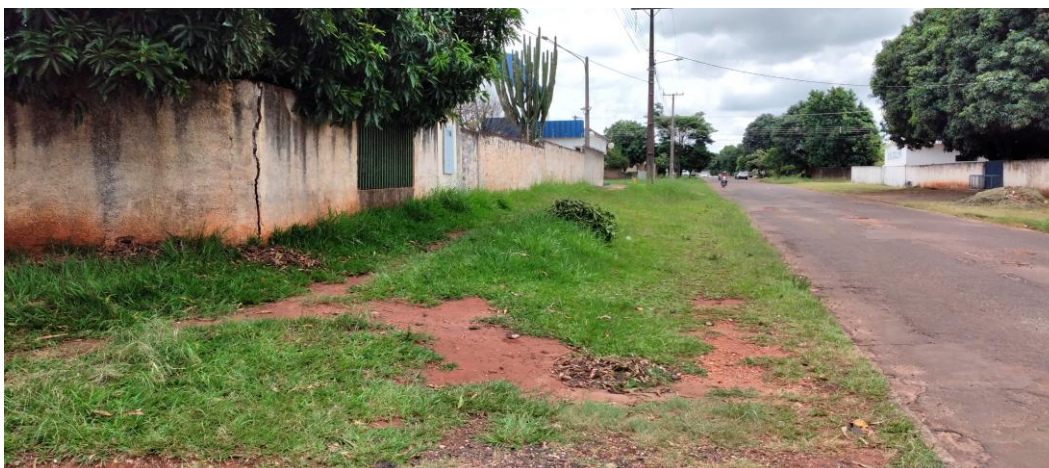
Foto 3: Calçada Externa Danificada e Muro Externo Danificado
