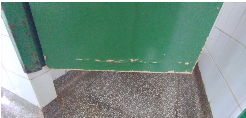
Foto 90: Porta do Sanitário Masculino Danificada
