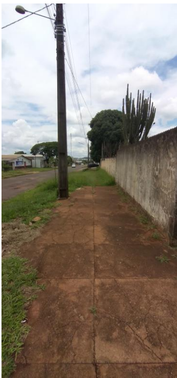
Foto 4: Calçada Externa Danificada
