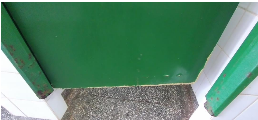
Foto 92: Porta do Sanitário Masculino Danificada
