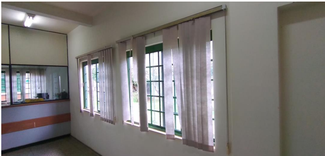
Foto 138: Janela da Área de Espera com Cortina Danificada
