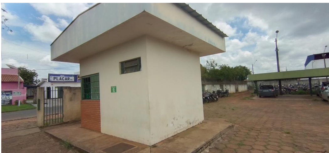
Foto 30: Guarita com Beiral Danificado
