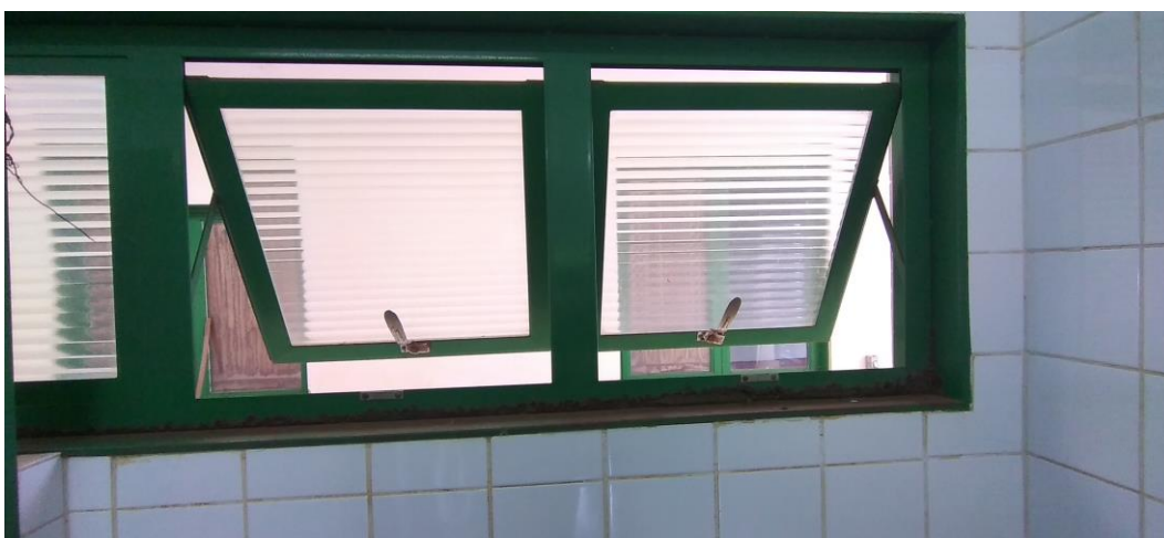
Foto 95: Janela do Banheiro Masculino Danificada
