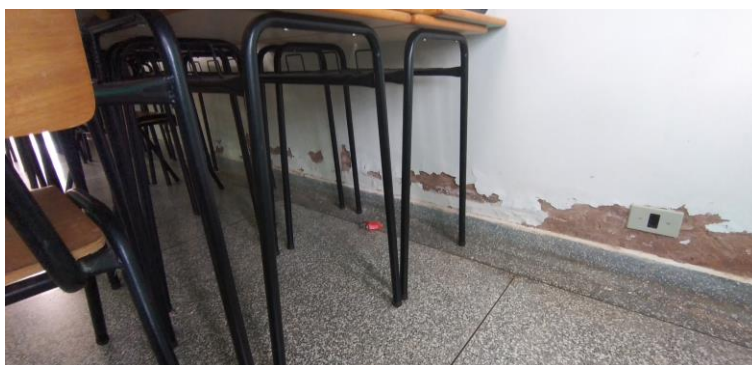
Foto 59: Parede da Sala de Aula Danificada
