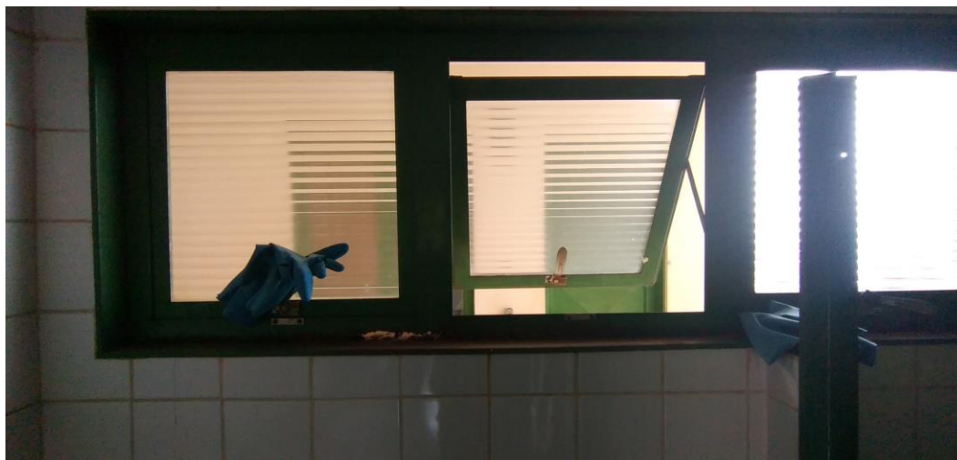
Foto 76: Janela do Banheiro Feminino Danificada
