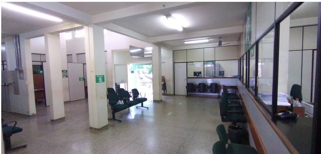
Foto 133: Área de Espera com Colunas Danificadas
