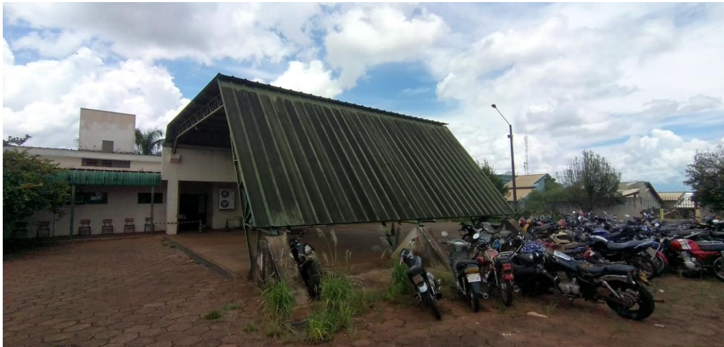
Foto 110: Telhado da Área de Vistoria Danificado
