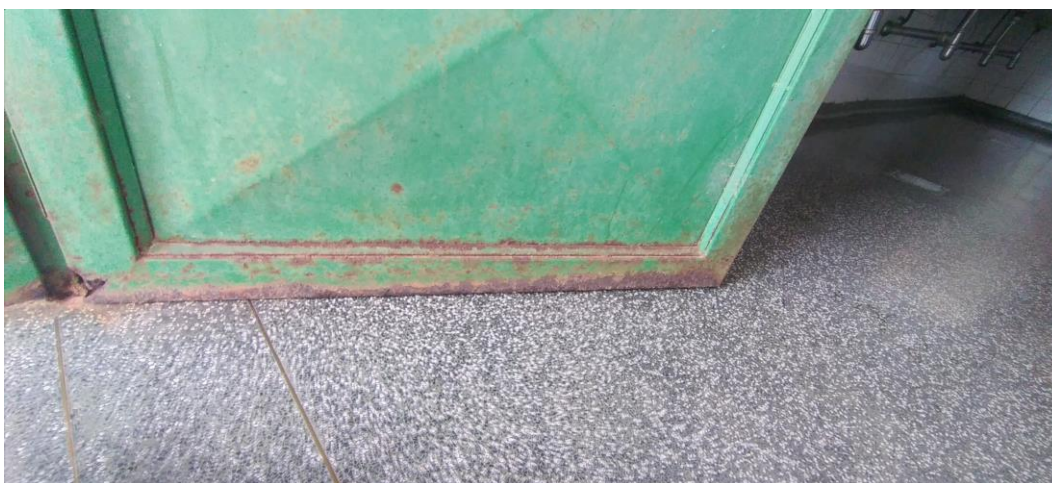
Foto 75: Porta de Acesso ao Banheiro Feminino Danificada
