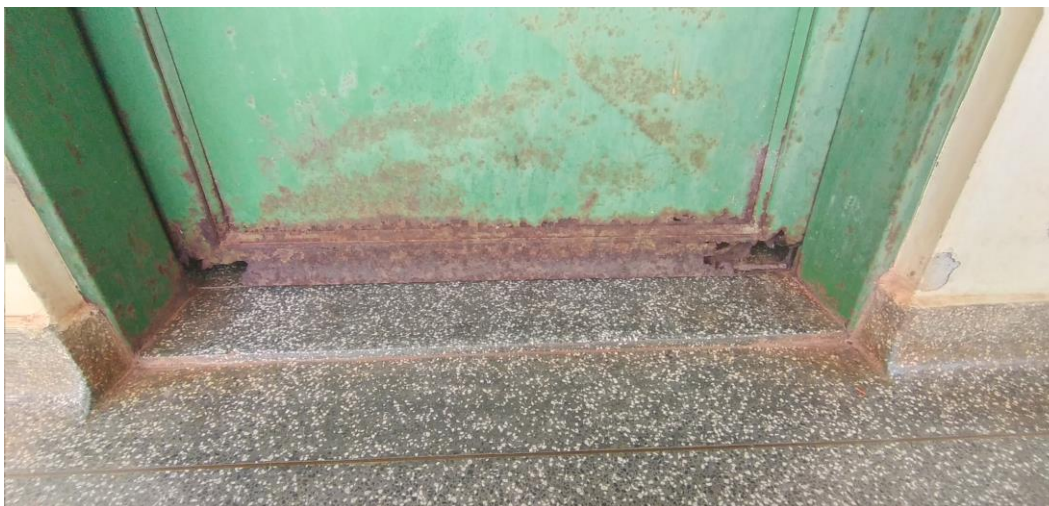
Foto 96: Porta de Acesso ao Banheiro Masculino Danificada
