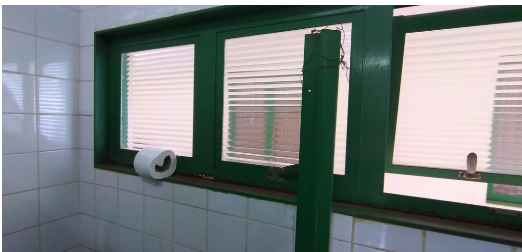
Foto 94: Janela do Banheiro Masculino Danificada
