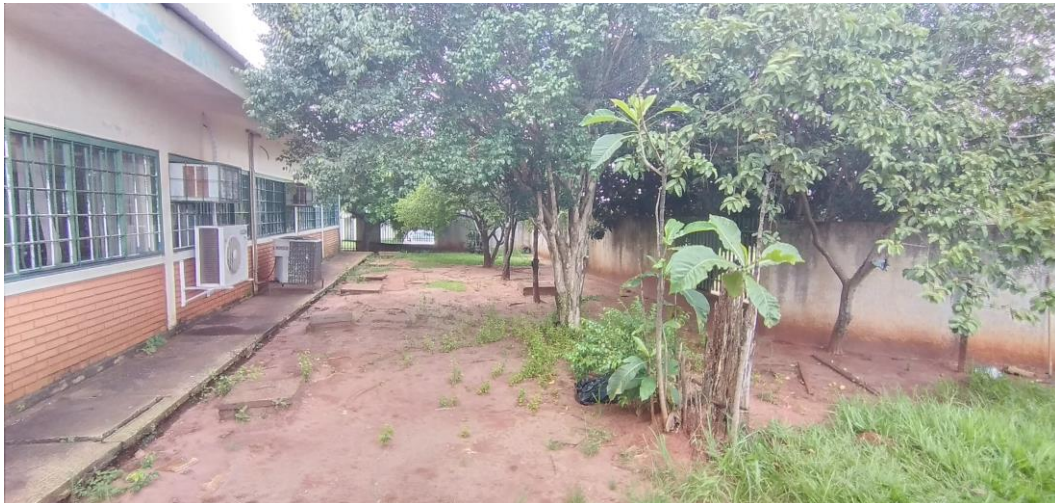
Foto 123: Jardim Lateral Danificado
