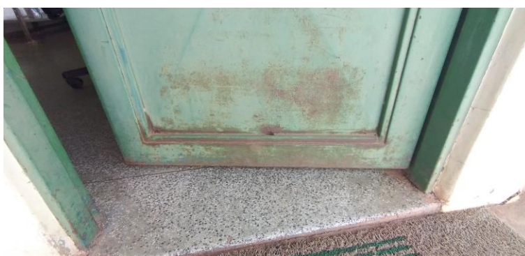
Foto 104: Porta de Acesso a Sala da Vistoria Danificada
