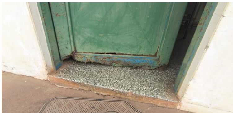
Foto 33: Porta da Guarita Danificada
