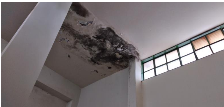
Foto 164: Laje da Área de Espera Danificada
