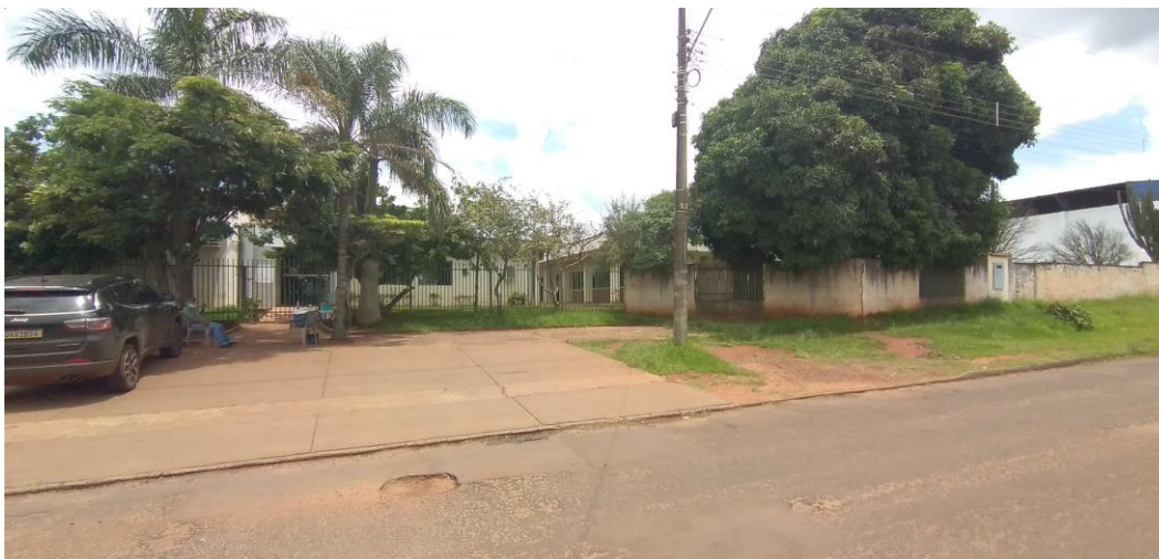
Foto 1: Calçada Externa Danificada
