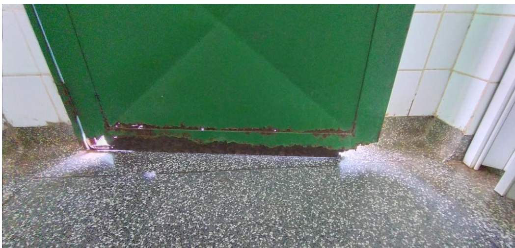
Foto 97: Porta de Acesso ao Banheiro Masculino Danificada
