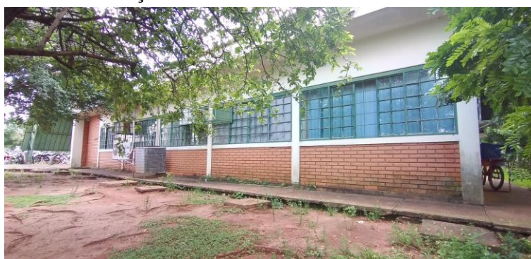
Foto 121: Fachada Lateral do Bloco Principal com Calçada Danificada
