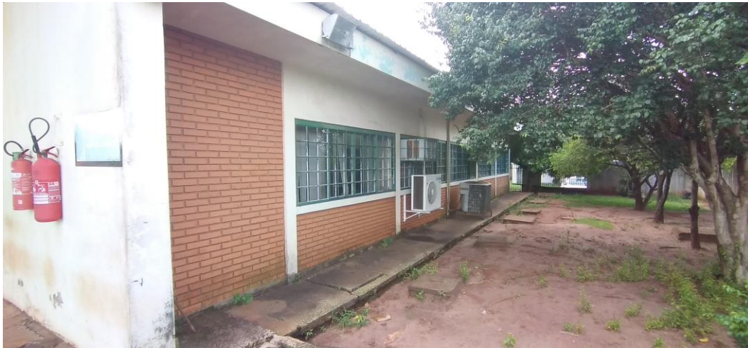
Foto 122: Fachada Lateral com Calçada Danificada
