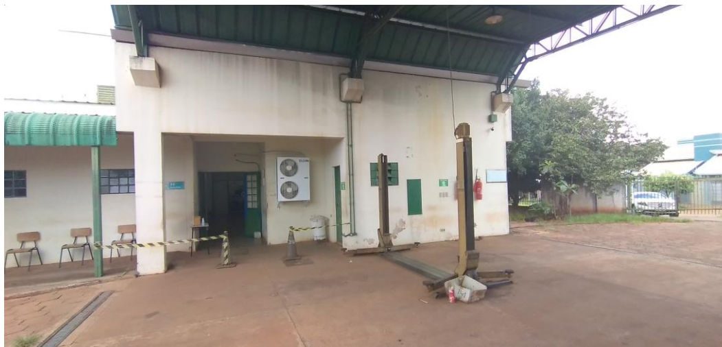
Foto 113: Área de Vistoria com Parede Danificada
