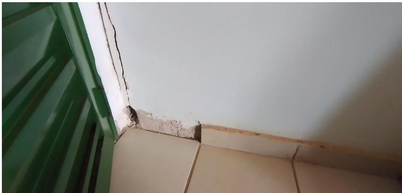
Foto 109: Rodapé e Parede do Arquivo Danificados
