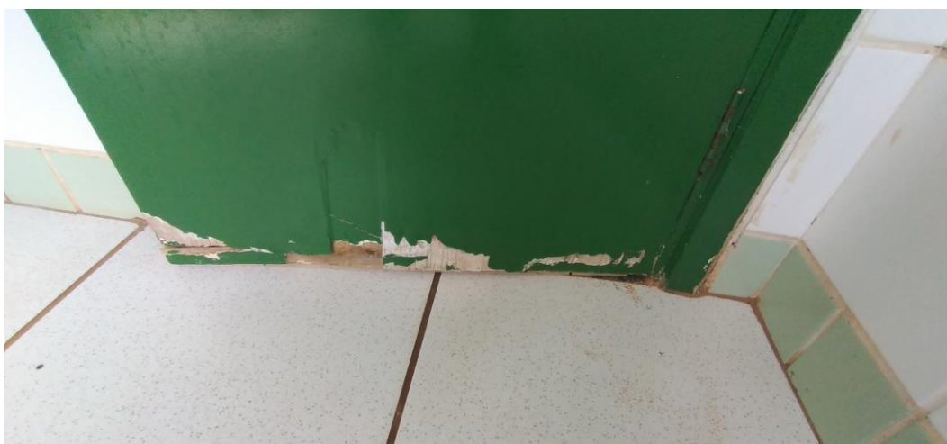
Foto 101: Porta do Banheiro Feminino de Funcionárias Danificada
