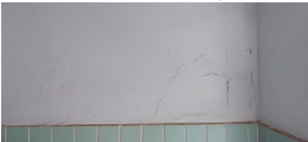
Foto 114: Parede da Copa Danificada
