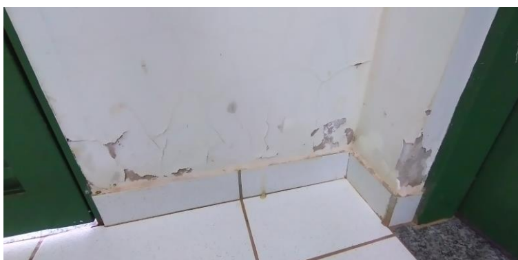
Foto 120: Parede da Área de Circulação Danificada
