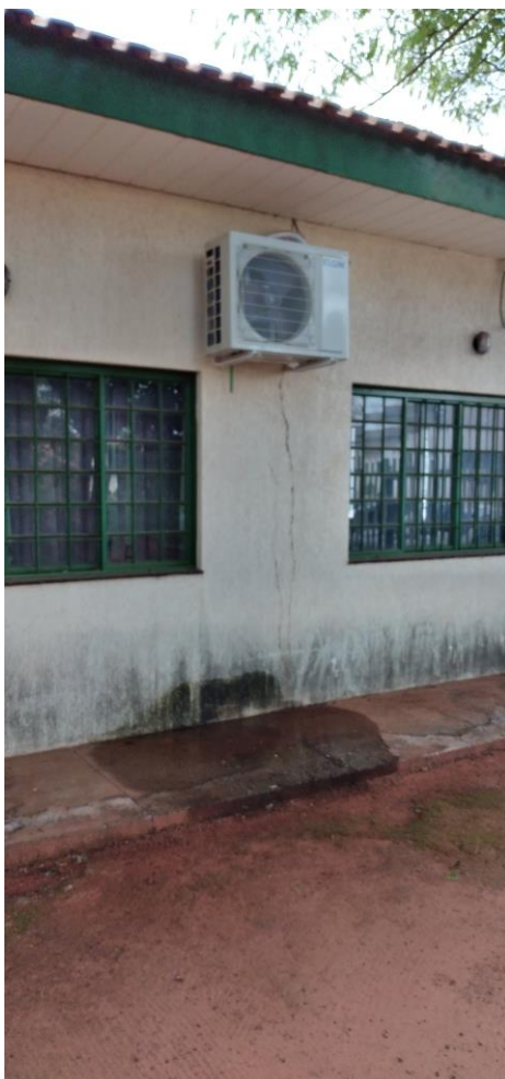
Foto 50: Dreno do Ar-Condicionado
