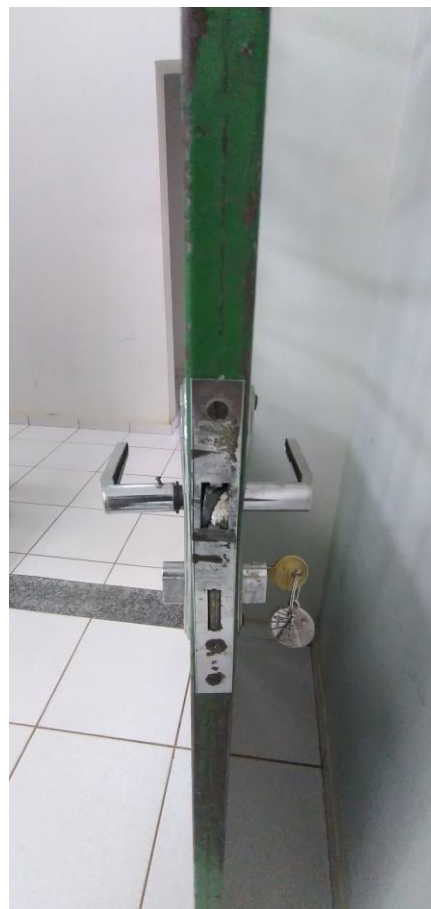
Foto 154: Maçaneta e Fechadura da Porta da Sala de Exames Danificada
