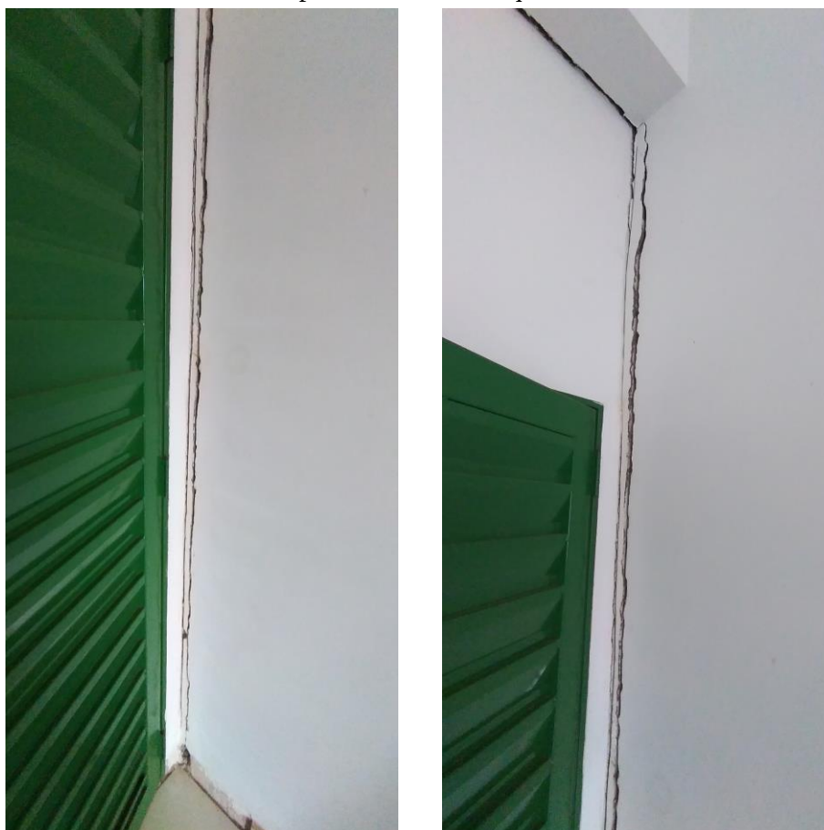
Fotos 110 e 111: Parede do Arquivo Danificada
