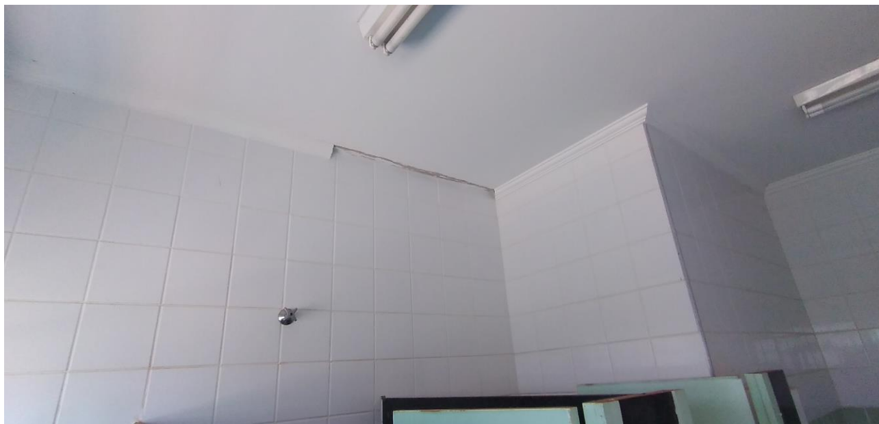
Foto 136: Moldura de Gesso do Banheiro Masculino Danificada
