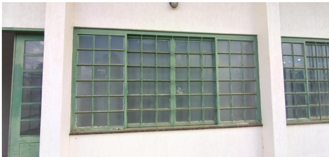
Foto 12: Janela na Fachada Frontal Danificada
