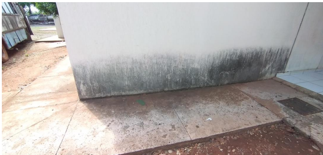
Foto 39: Fachada Posterior Danificada
