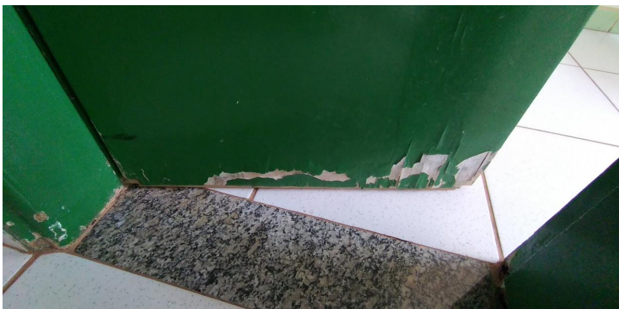
Foto 88: Porta do Banheiro Masculino de Funcionários Danificada
