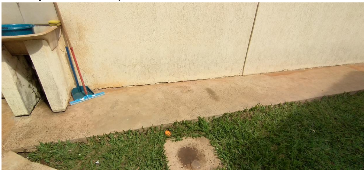
Foto 35: Encontro da Calçada com Parede Danificado
