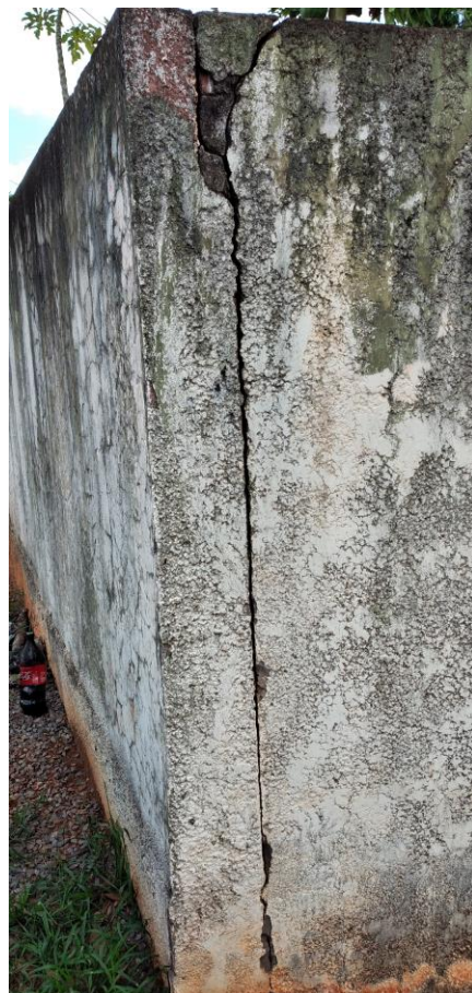
Foto 9: Muro Externo Danificado
