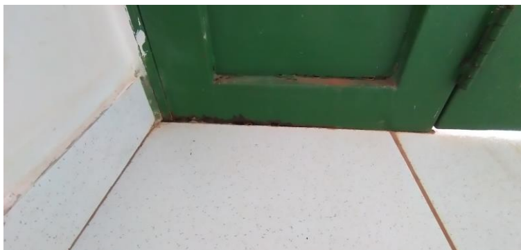
Foto 119: Encontro do Piso com a Porta Danificado
