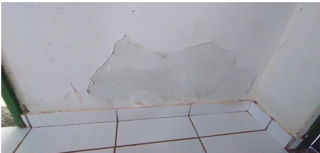
Foto 112: Parede da Área de Circulação Danificada
