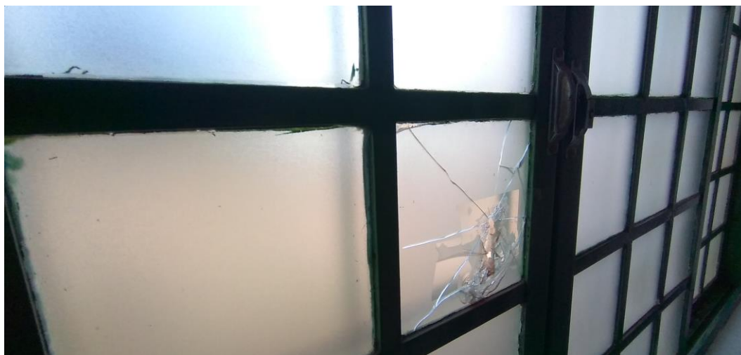
Foto 68: Janela da Sala de Captura de Imagem Danificada
