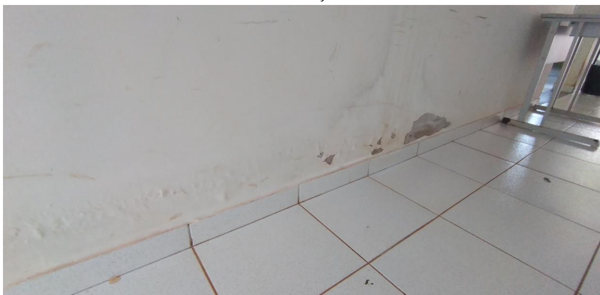
Foto 118: Parede da Área de Circulação Danificada
