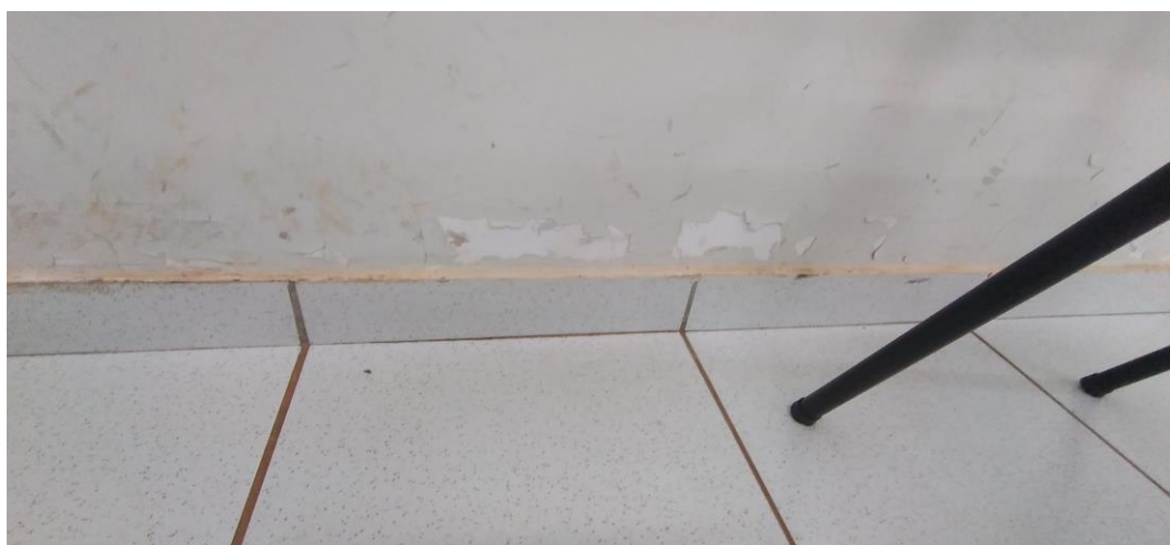
Foto 158: Parede da Sala de Exames Danificada
