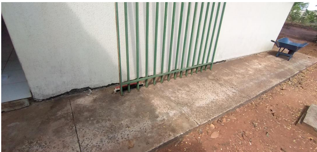
Foto 42: Encontro da Parede e Calçada Danificado
