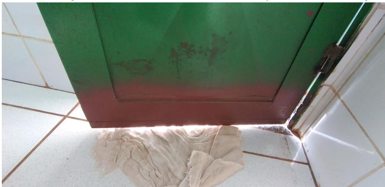
Foto 81: Porta de Acesso a área de Serviço Danificada
