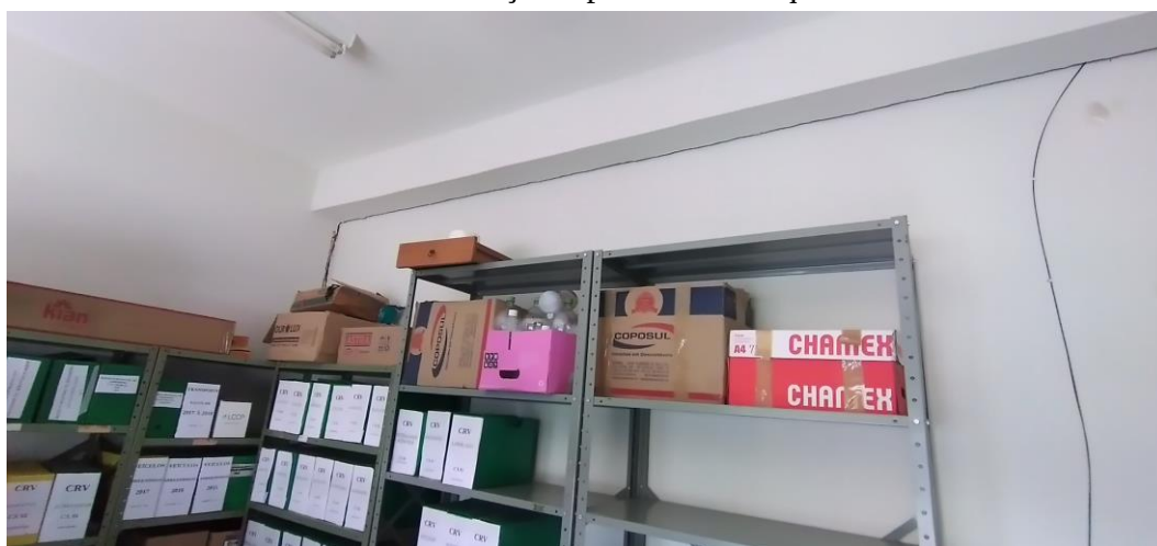
Foto 108: Parede do Arquivo Danificada
