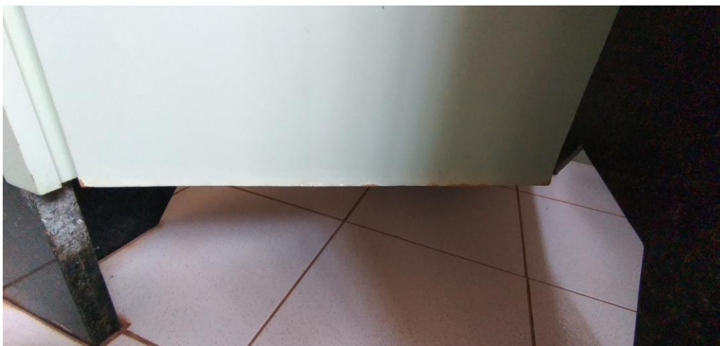
Foto 150: Porta do Sanitário Feminino Danificada
