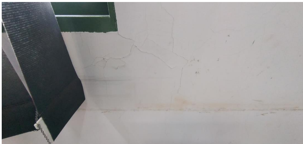
Foto 159: Parede da Sala de Exames Danificada
