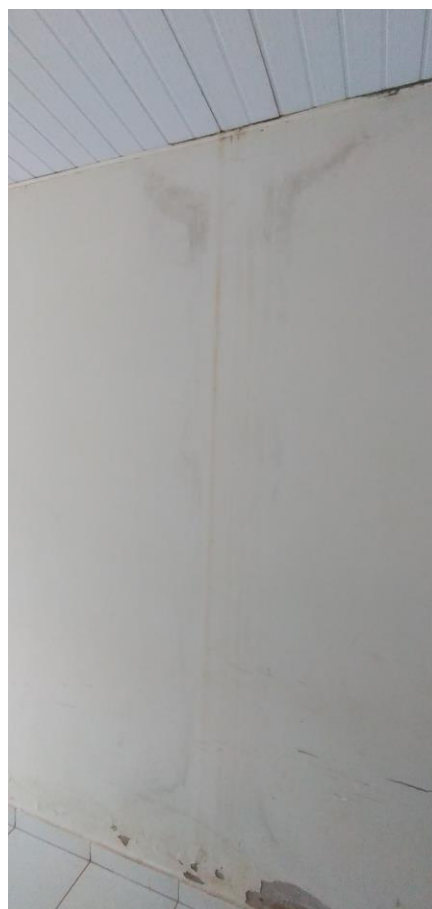
Foto 117: Parede da Área de Circulação Danificada
