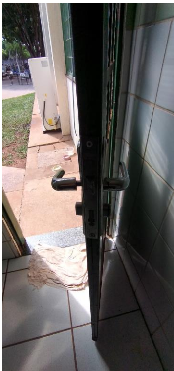
Foto 82: Maçaneta e Fechadura da Porta de Acesso a Área de Serviço Danificadas
