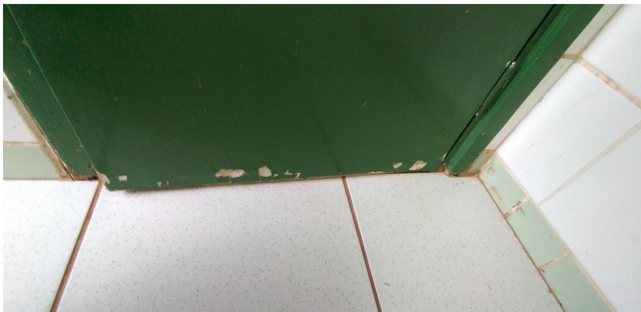
Foto 91: Porta do Banheiro Masculino de Funcionários Danificada
