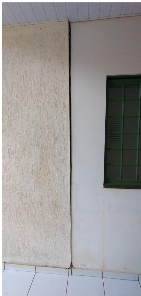
Foto 49: Parede do Acesso ao Interior da Agência Danificada
