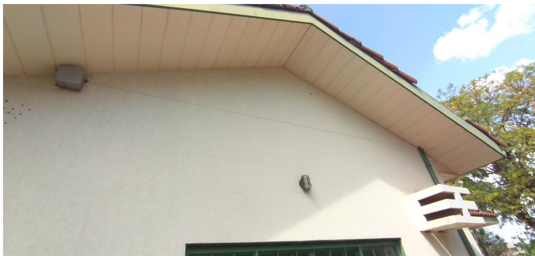
Foto 37: Fachada Posteiro Danificada
