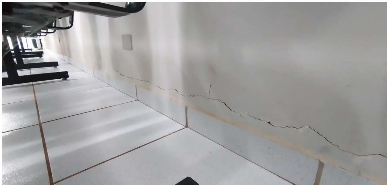
Foto 70: Parede da Área de Atendimento Danificada
