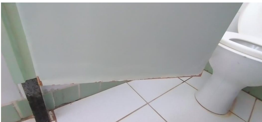
Foto 135: Porta do Sanitário Masculino Danificada
