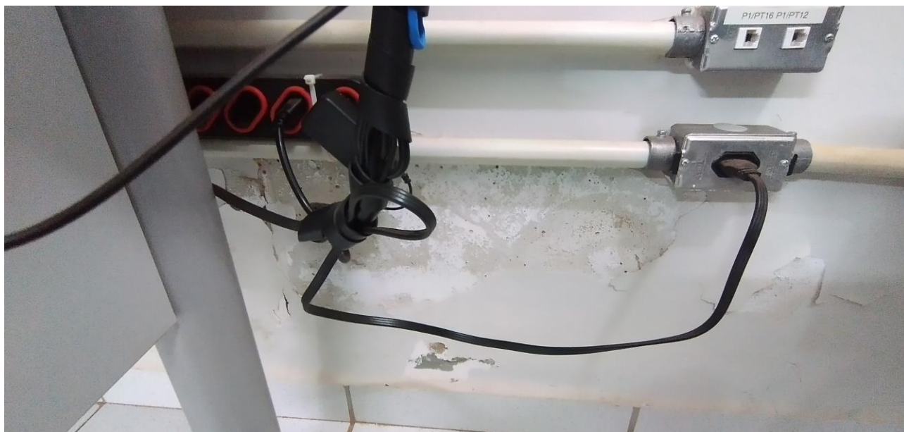
Foto 66: Parede da Sala do Gerente Danificada
