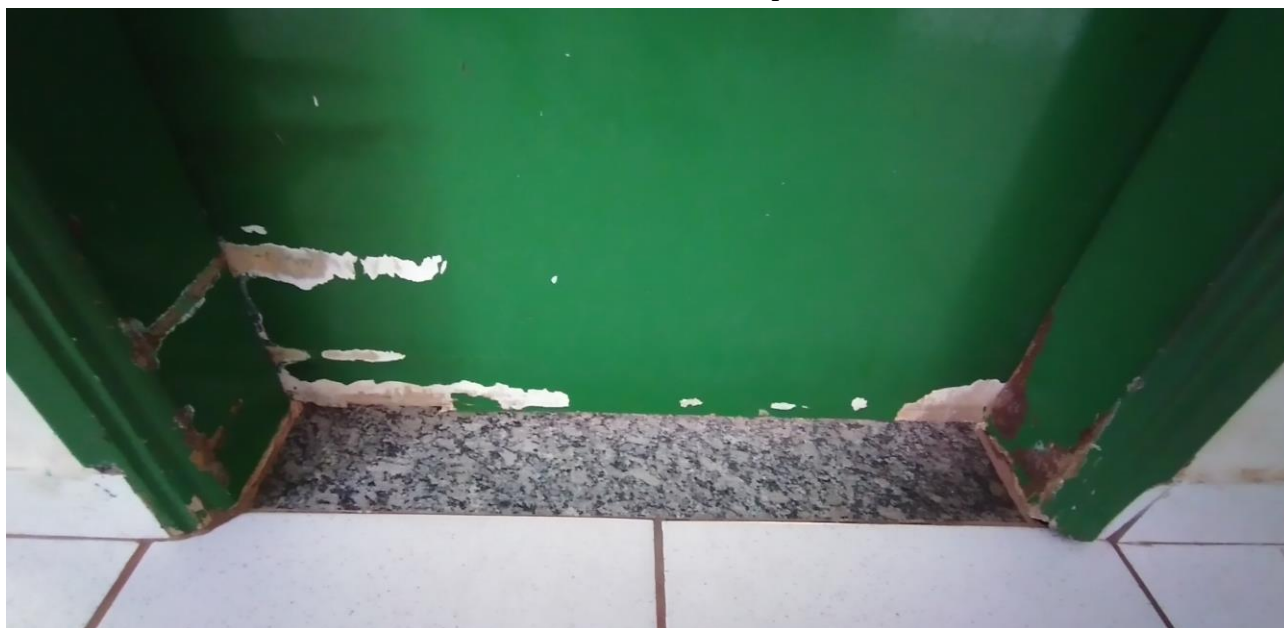
Foto 77: Porta da Copa Danificada
