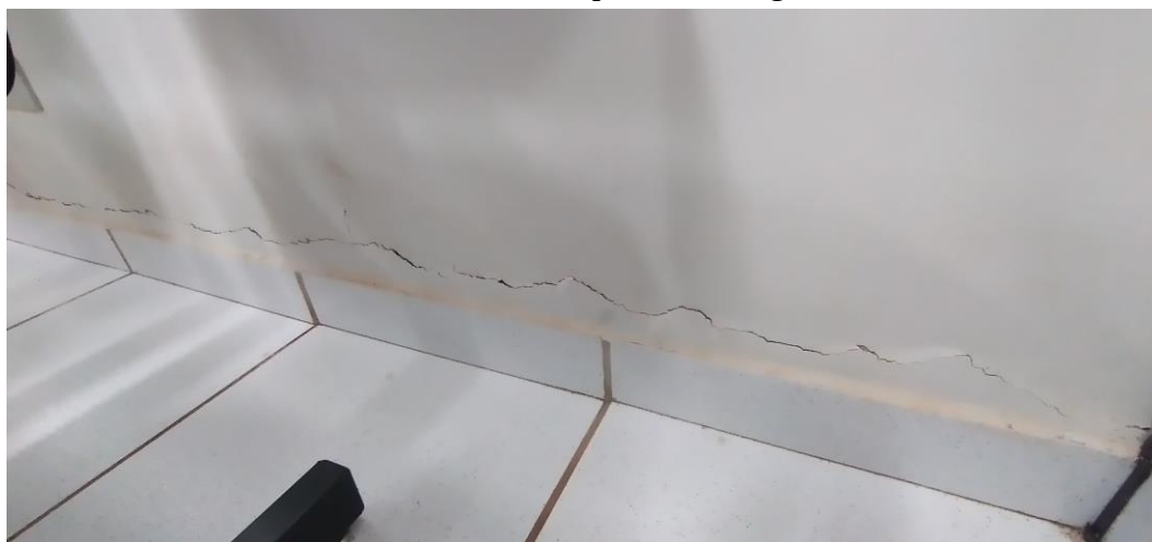
Foto 69: Parede da Área de Atendimento Danificada
