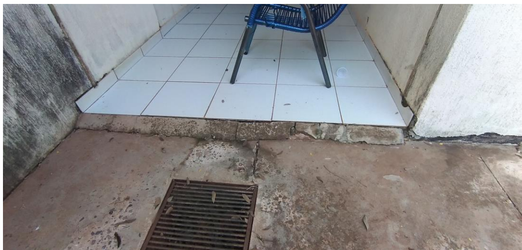
Foto 40: Calçada Interna de Acesso ao Interior da Agência Danificada
