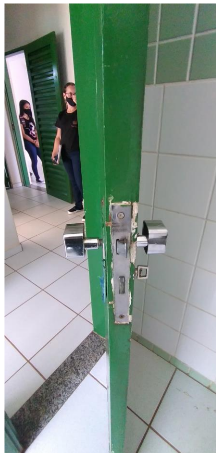
Foto 87: Maçaneta e Fechadura Danificadas
