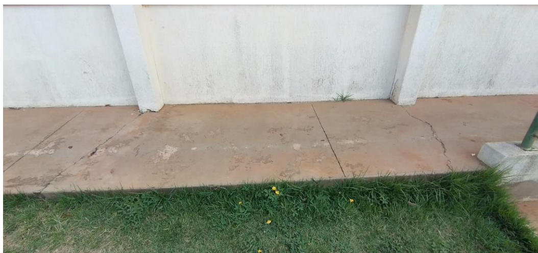
Foto 13: Calçada Externa Danificada
