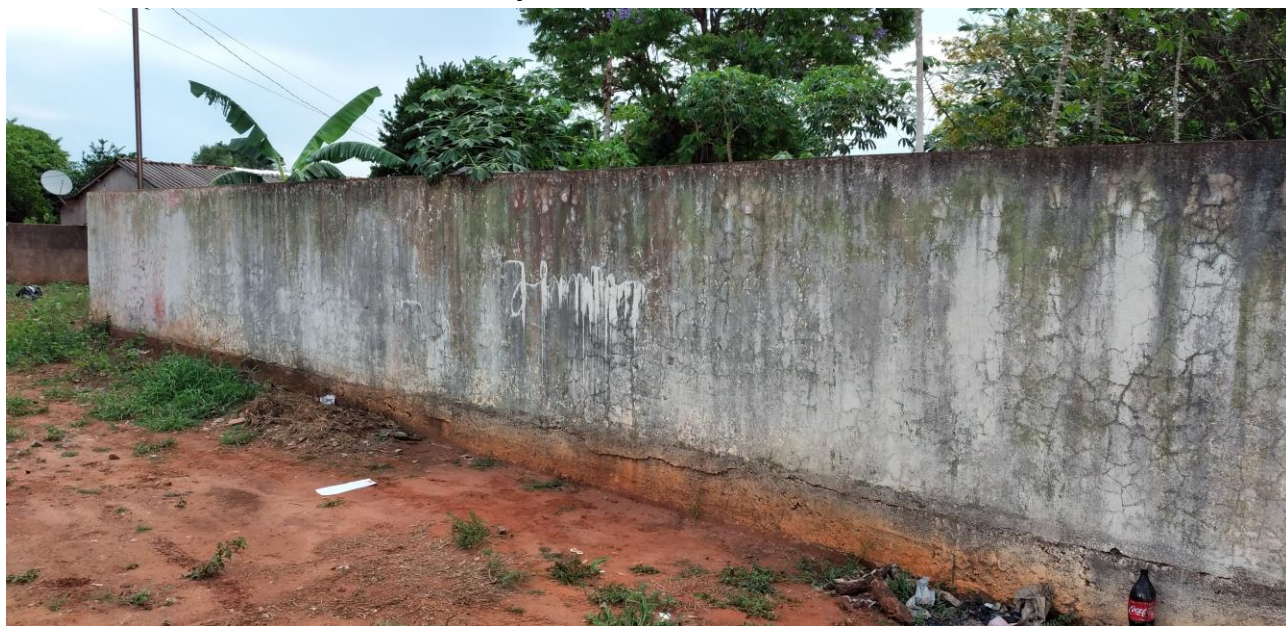
Foto 10: Muro Externo Danificado
