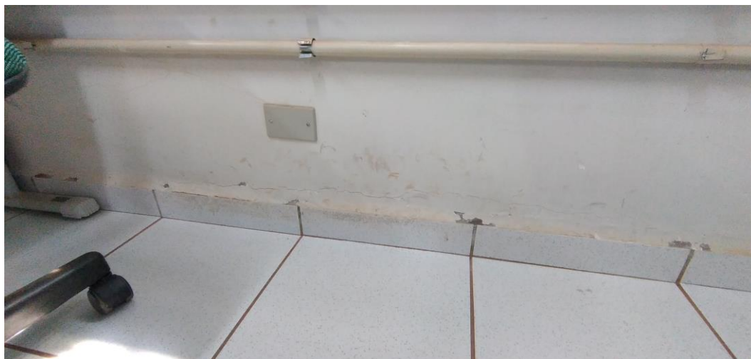
Foto 67: Parede da Sala do Gerente Danificada
