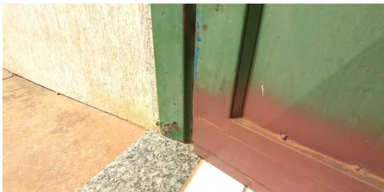
Foto 84: Portal da Porta de Acesso a Área de Serviço Danificado
