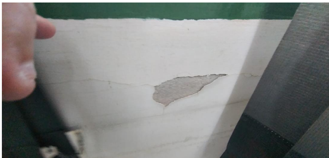
Foto 160: Parede da Sala de Exames Danificada
