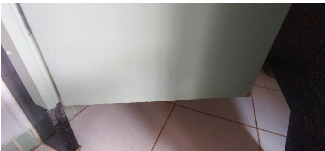
Foto 151: Porta do Sanitário Feminino Danificada
