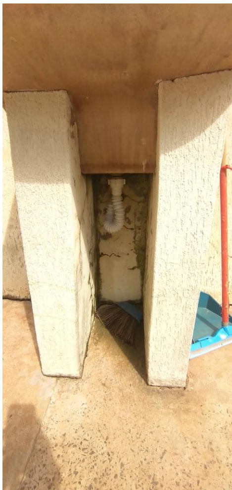
Foto 33: Tanque na Área de Serviço Danificado
