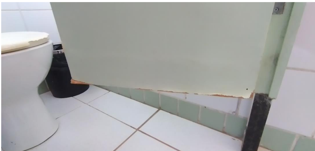
Foto 149: Porta do Sanitário Feminino Danificada
