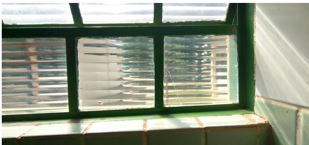
Foto 94: Janela do Banheiro Masculino de Funcionários Danificada
