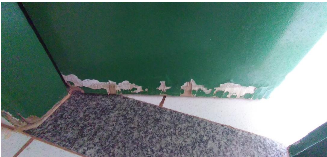
Foto 99: Porta do Banheiro Feminino de Funcionárias Danificada
