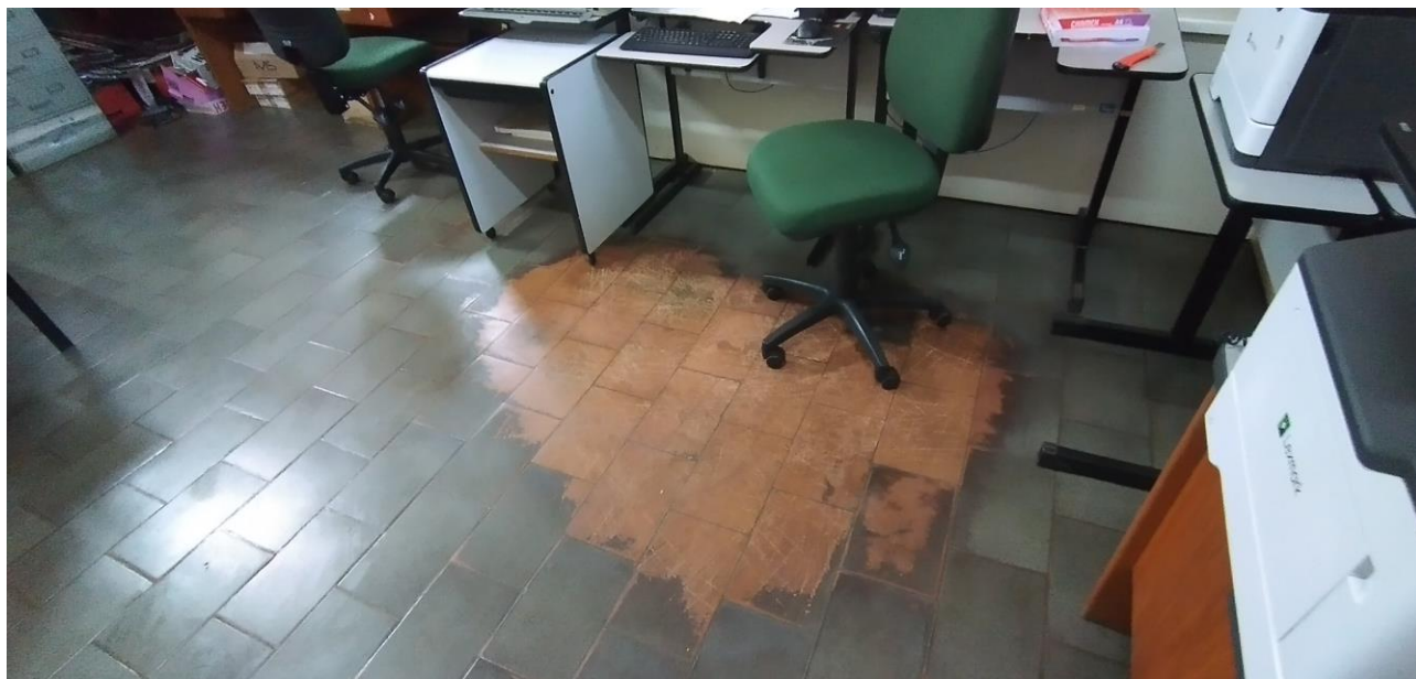
Foto 41: Piso do Administrativo Danificado
