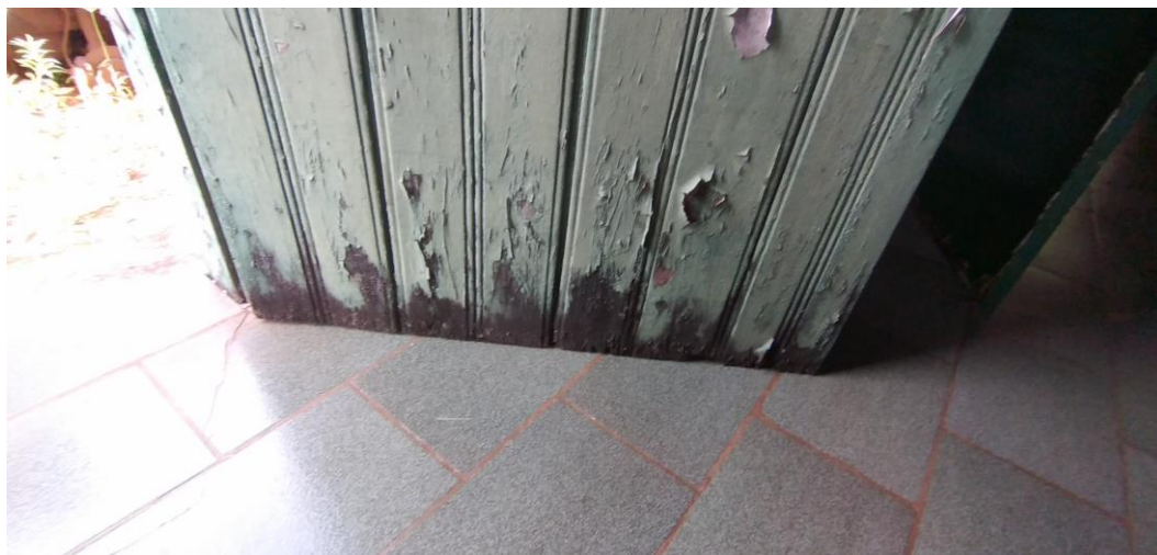
Foto 53: Porta de Acesso ao Pátio Interno Danificada
