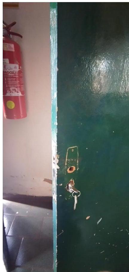
Foto 47: Maçaneta e Fechadura Danificados
