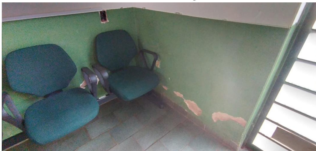
Foto 19: Parede da Área de Atendimento Danificada
