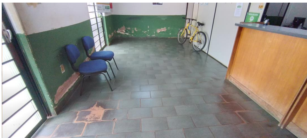
Foto 20: Piso da Área de Atendimento Danificado
