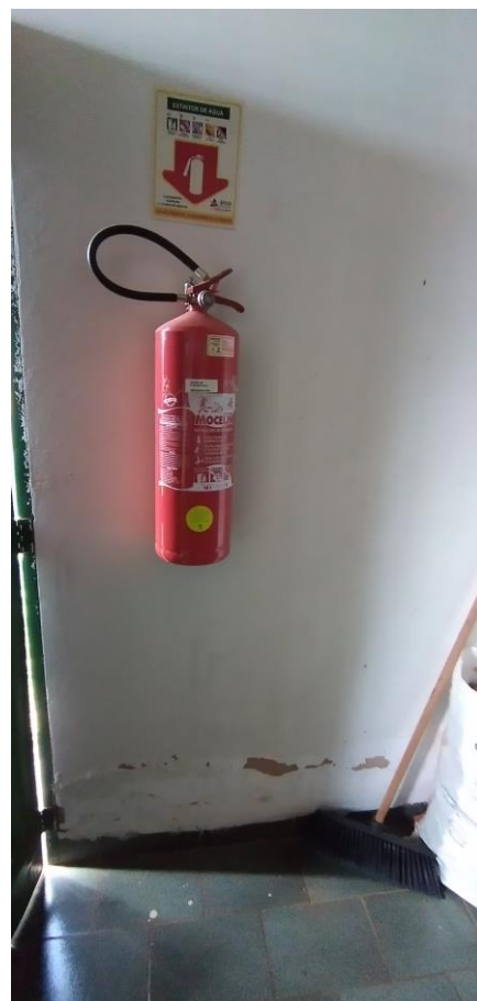
Foto 52: Parede do Arquivo Danificada
