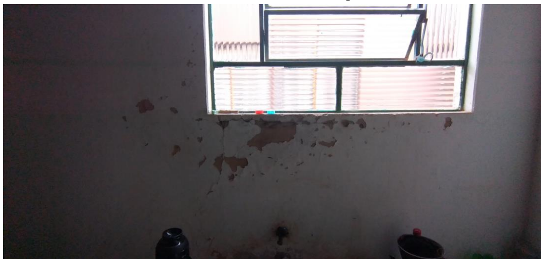
Foto 31: Parede da Copa Danificada
