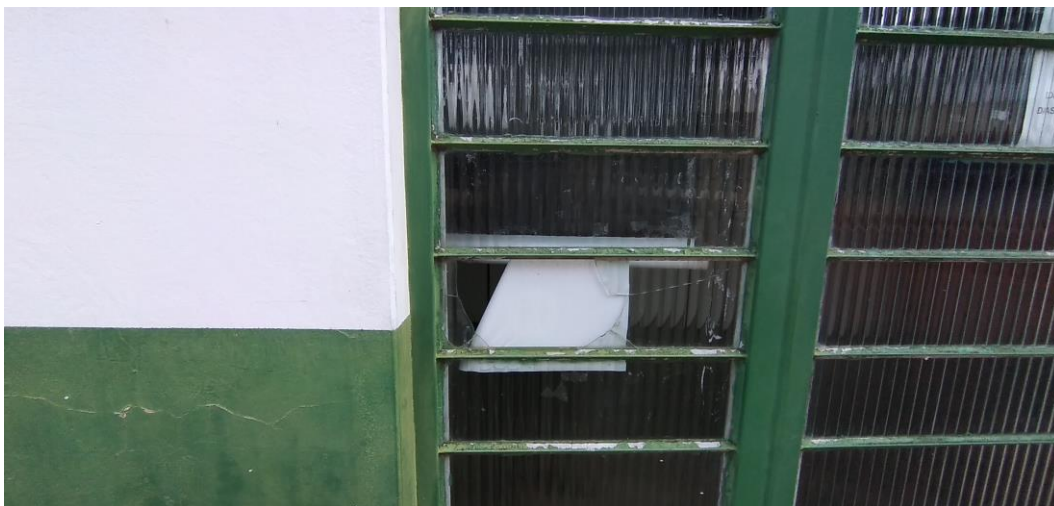
Foto 8: Porta de Acesso Principal Danificada
