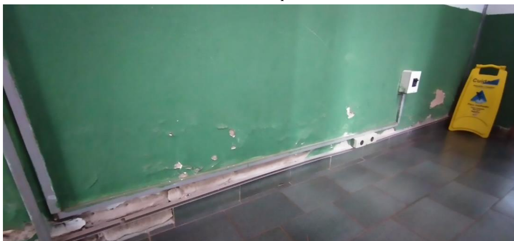
Foto 55: Parede da Área de Circulação Danificada
