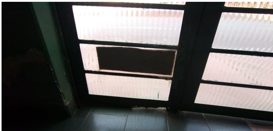
Foto 18: Porta de Acesso Principal Danificada
