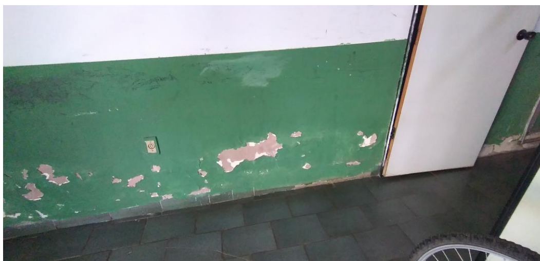
Foto 22: Parede da Área de Atendimento Danificada
