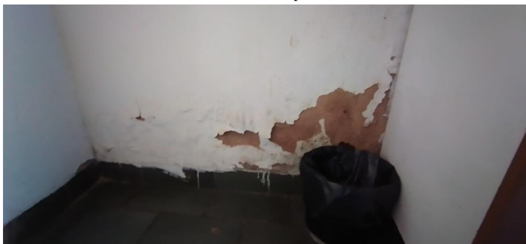
Foto 32: Parede da Copa Danificada
