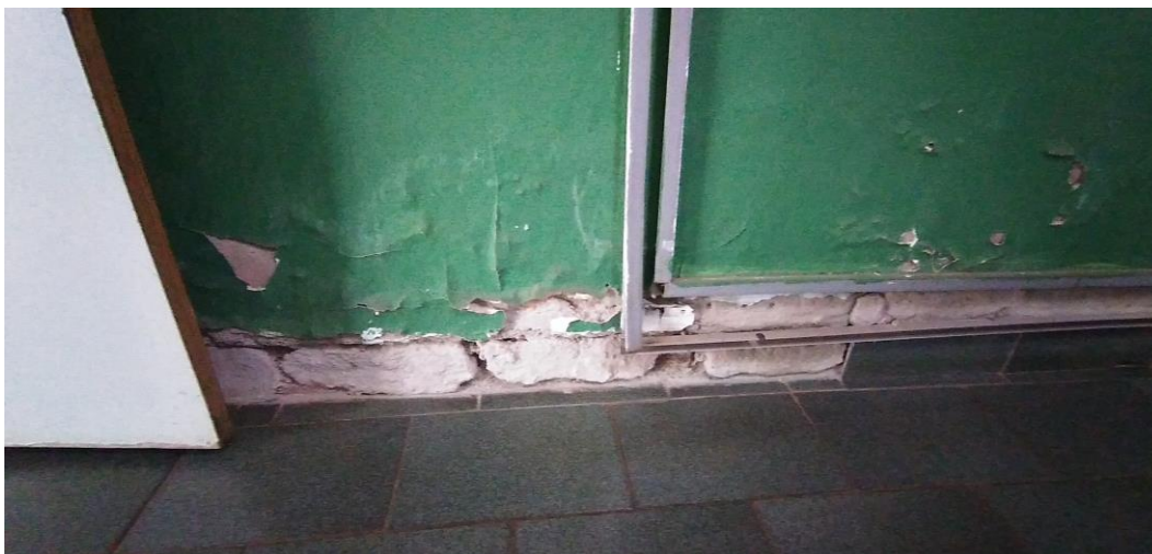
Foto 56: Parede da Área de Circulação Danificada
