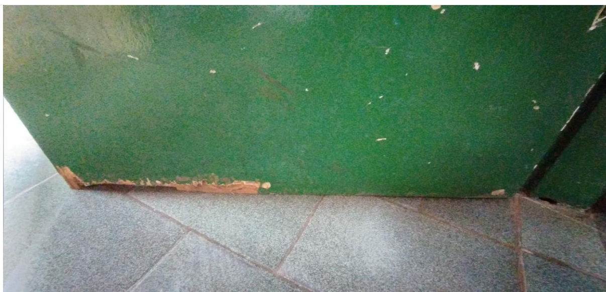
Foto 48: Porta de Acesso ao Arquivo Danificada
