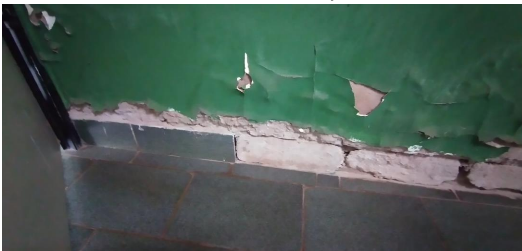
Foto 57: Parede da Área de Circulação Danificada
