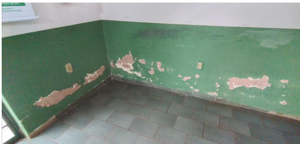
Foto 21: Parede da Área de Atendimento Danificada
