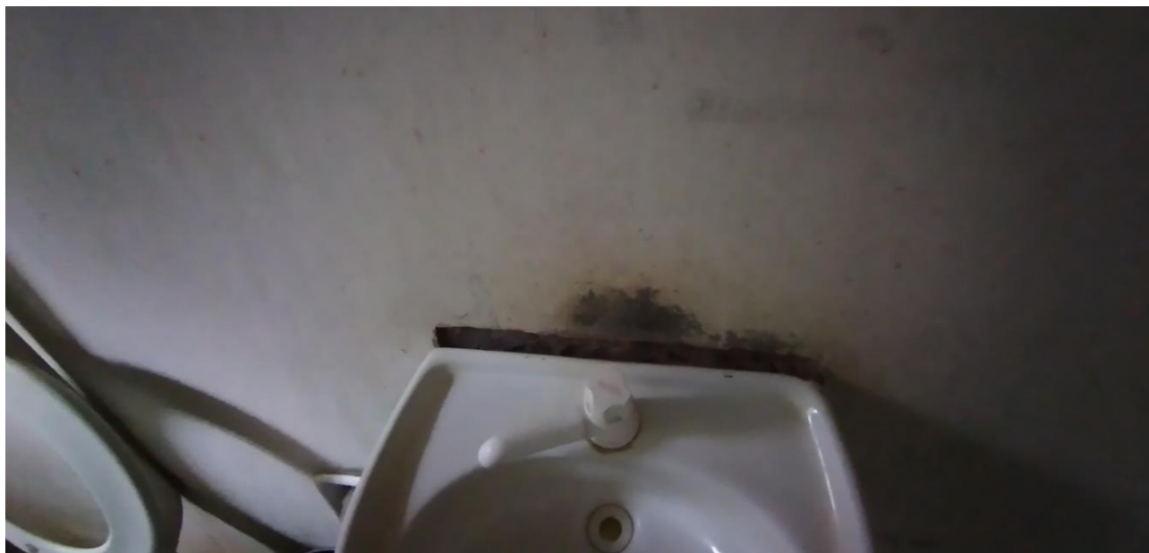
Foto 36: Pia do Banheiro Danificada
