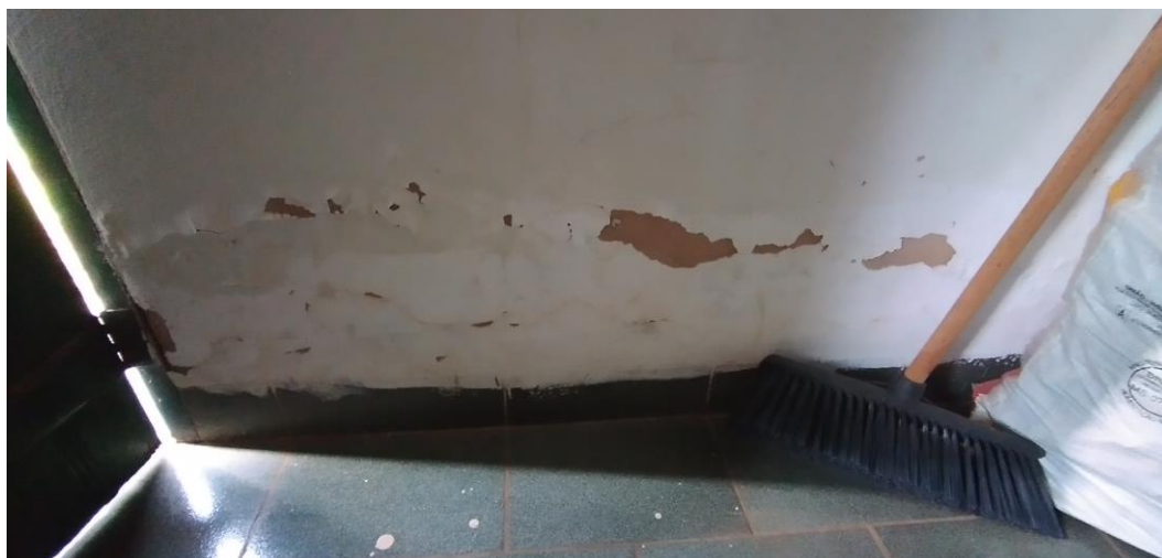
Foto 54: Parede do Arquivo Danificada
