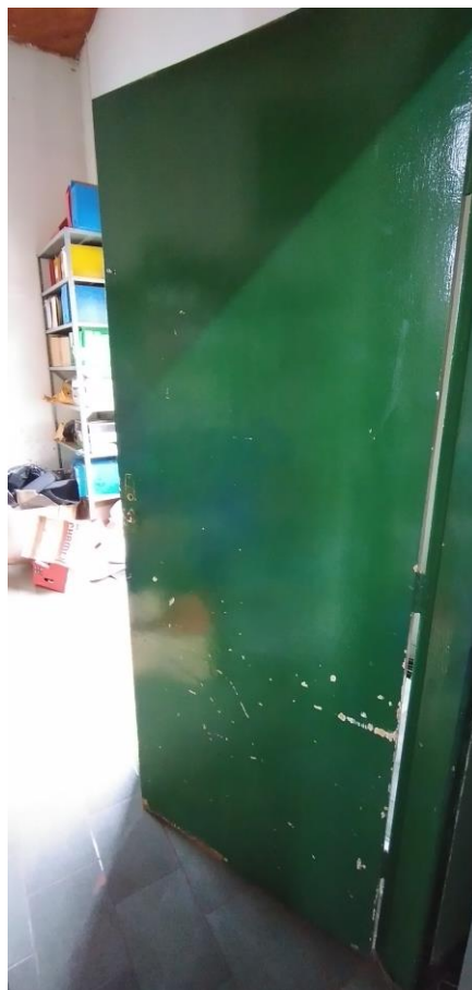
Foto 46: Porta de Acesso ao Arquivo Danificada
