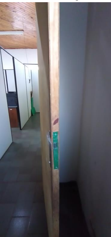
Foto 28: Maçaneta e Fechadura Danificadas
